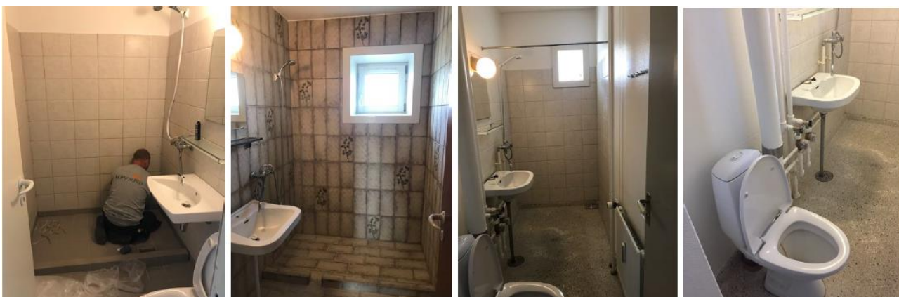
Badeværelser i forskellig stand, udformning og alder. Installationer oftest skjulte, men stedvist synlige.
