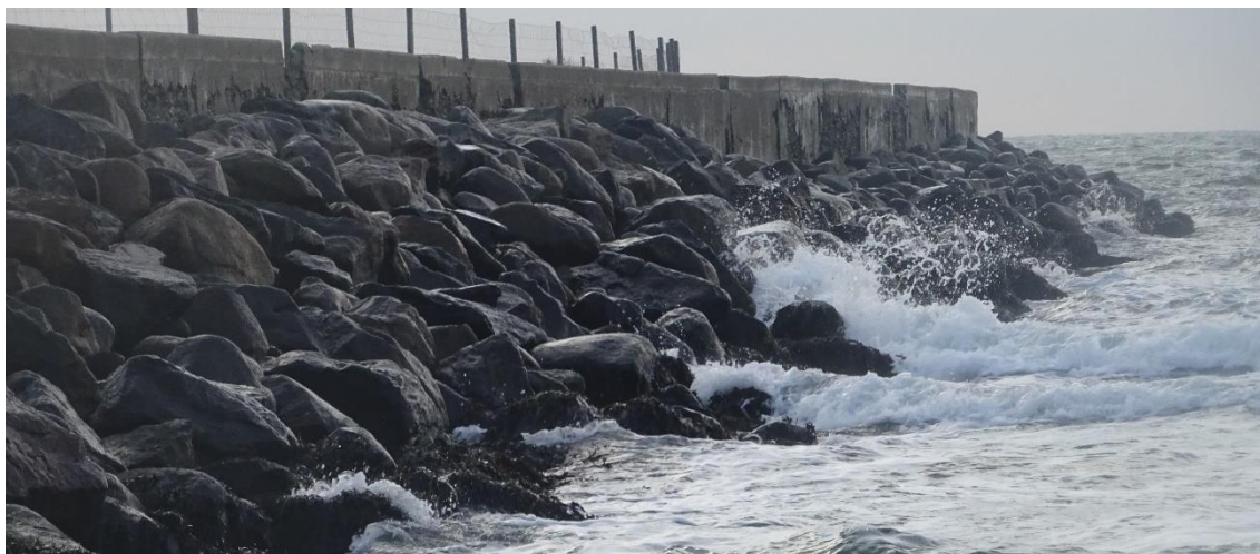
Figur 8: Overgang mellem inderste og midterste del af molen, hvor sten begynder at mangle på ydersiden.
