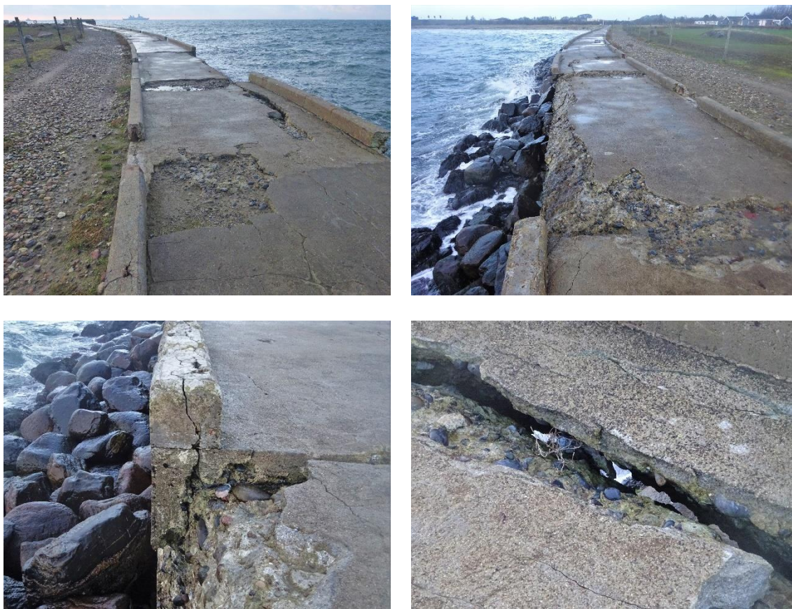
Figur 6: Eksempelfotos på nogle af de værste skader på betonoverbygningen på molen.
