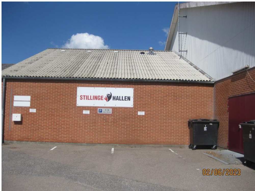
Bølgeeternittag fra 1988 med asbest
