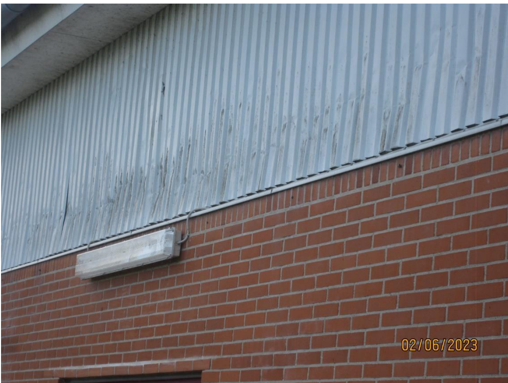
Bulede og skadede metalprofilplader mod boldbanen
