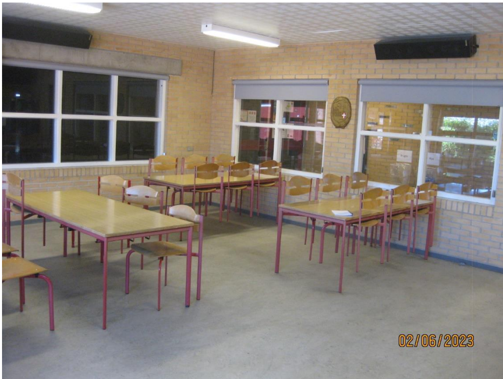
Slidt og skadet linoleumsgulv i cafeteria
