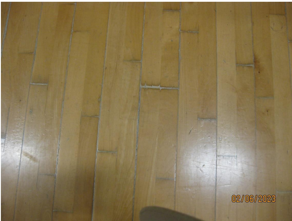
Gulv viser tegn på vandskader
