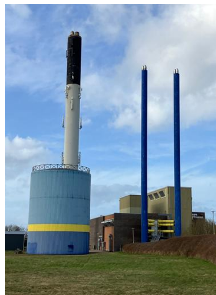
Varmecentral til reservelast i Korsør.
