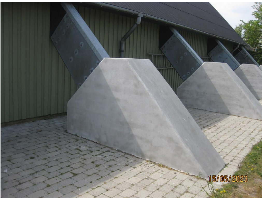
Spærankrene langs begge facader fremstår i meget pæn stand efter istandsættelsen af alkalisk skader i betonen.
