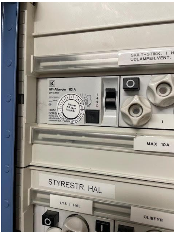
HFI-relæer, bør udskiftes til HPF
