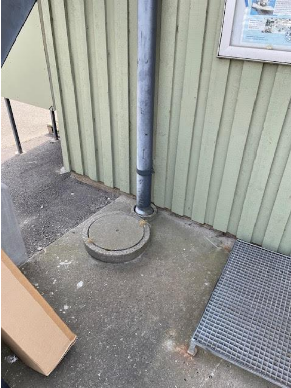
Brønddæksler over sandfang er af beton, disse bør udskiftes til støbegods
