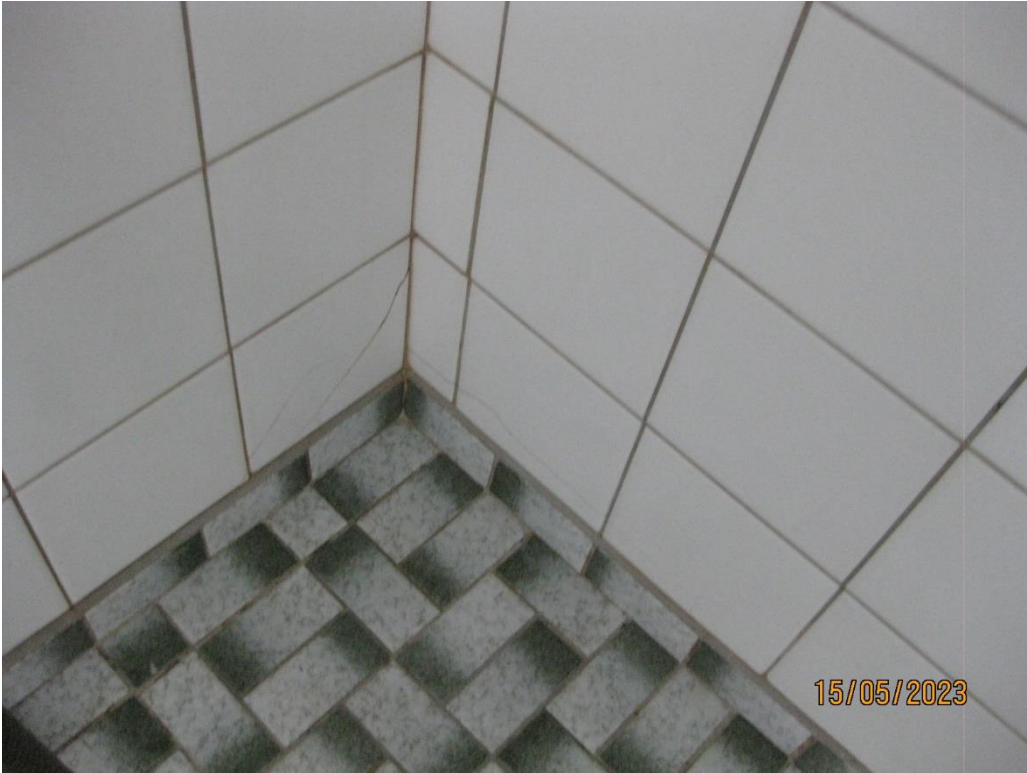
Defekte fliser i bruserum
