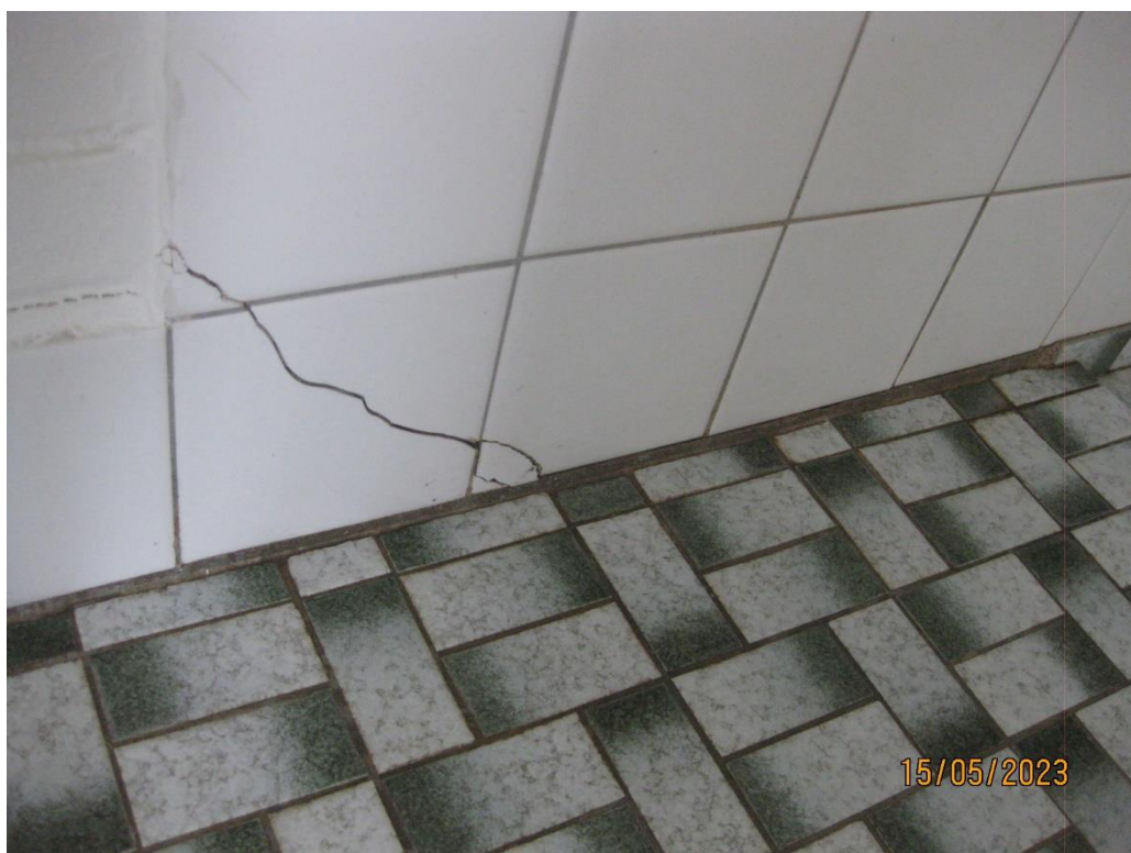
Defekte fliser i bruserum
