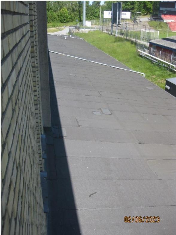
Tagpap på sidebygning med flere reparationer
