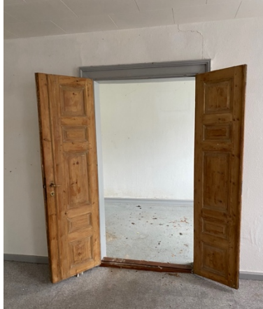
Dørparti i stueetage med sætningsrevner
