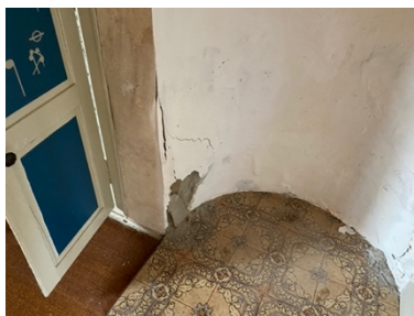
Skader på indvendig murværk
