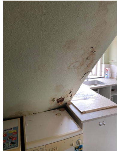
Fugtskjolder fra vandskade
