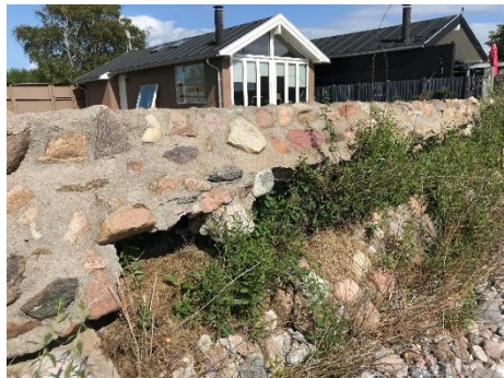
2. Nærbillede af skadet mur.
