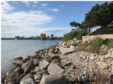
1. Stenkastning med skadet væg nordligste del.
