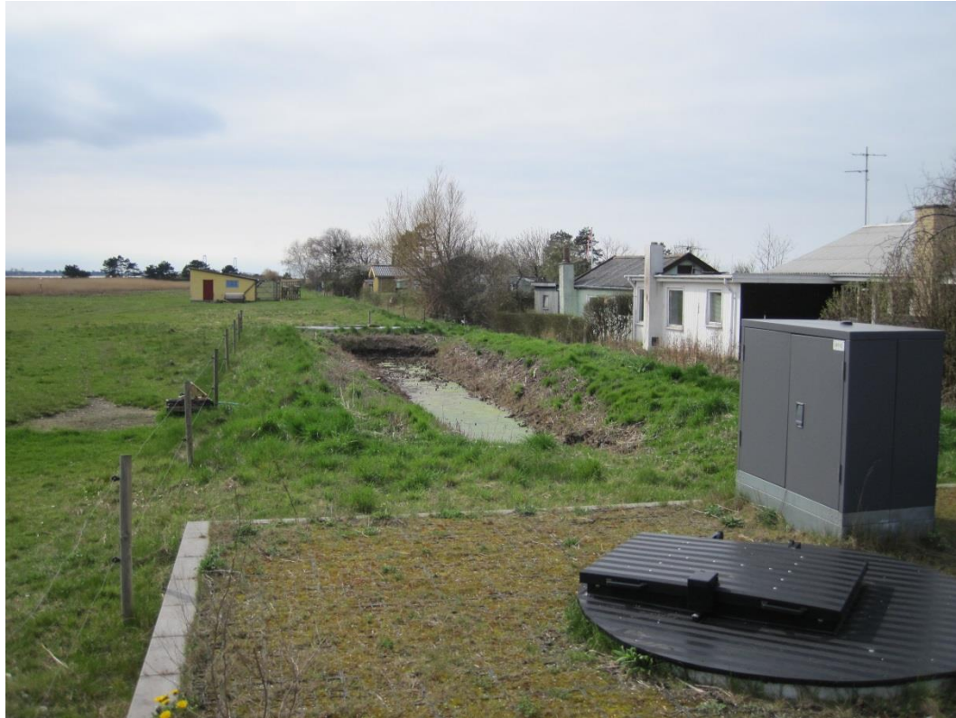
Figur 2.6: Pumpestation og regnvandsbassin ved Bildsøvej
