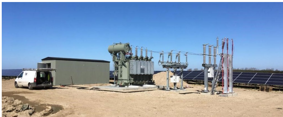
Figur 1-6 Eksempel på stepup-transformer og en teknikbygning.
