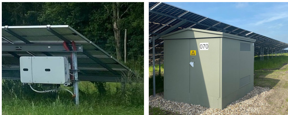
Figur 1-5 Eksempel på en inverter (t.v.) og en transformer (t.h.).
