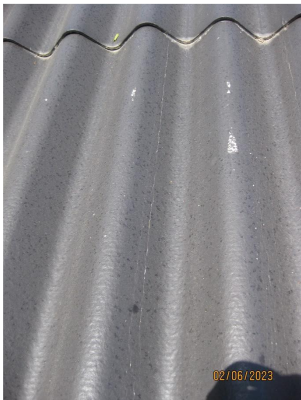
Revne i tagplade som bør udskiftes
