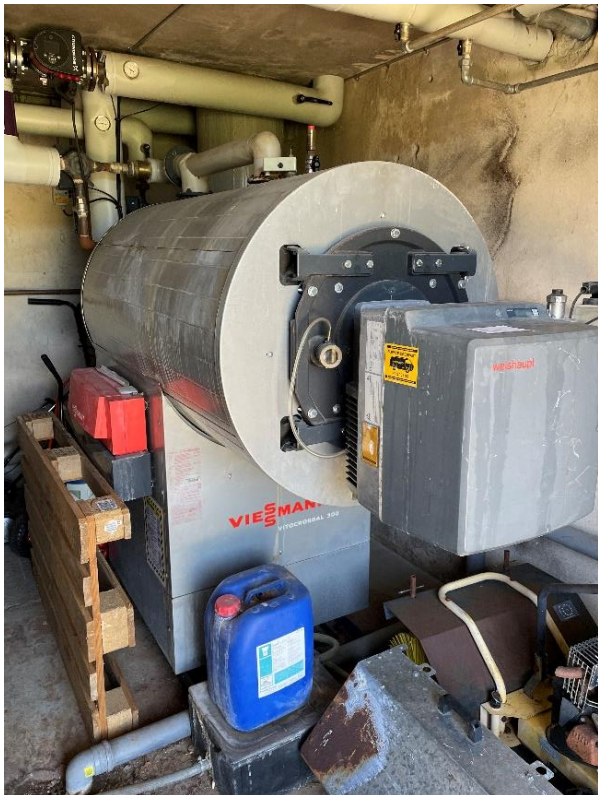
Gasfyr som forventes konverteret til fjernvarme i 2024
