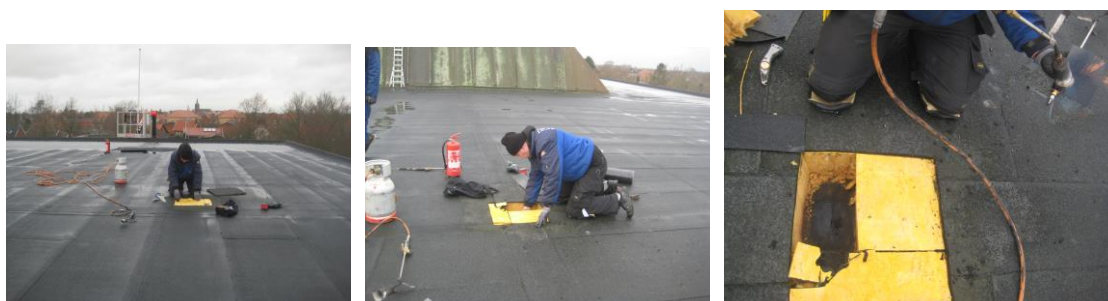
Undersøgelse i tagflade, hvor opskåret dampspærre er retableret med påsvejt tagpap.
