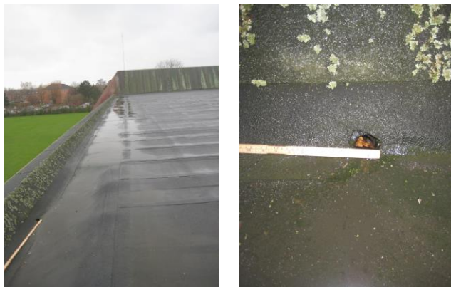
Små Ø50 mm tagnedløbsbrønde – 3 stk. pr. facade (kan ikke tage et tordenregnskyl)
