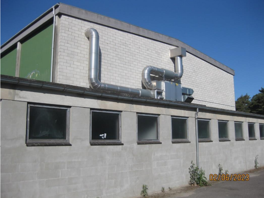
Vinduer til udskiftning
