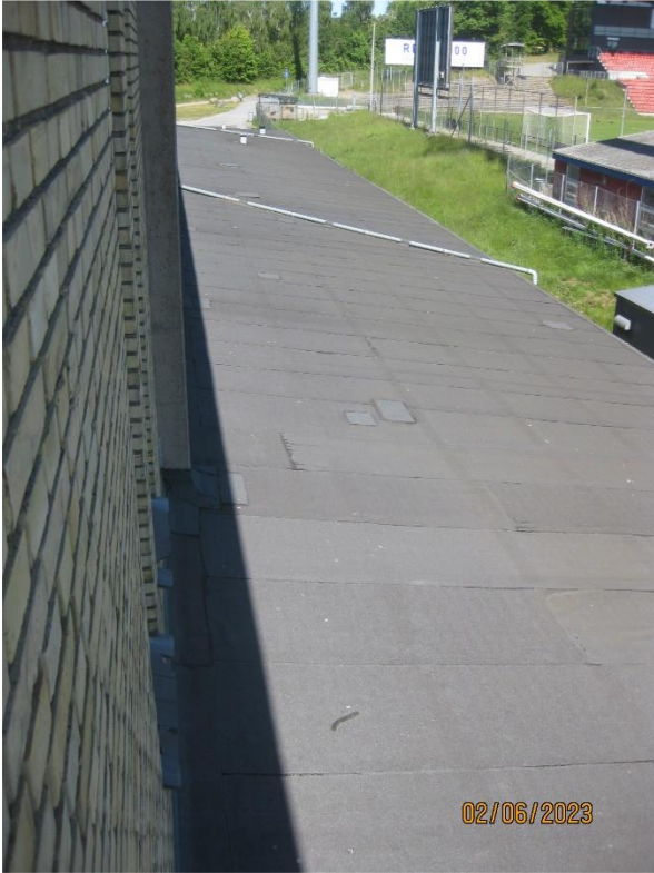
Tagpap på sidebygning med flere reparationer
