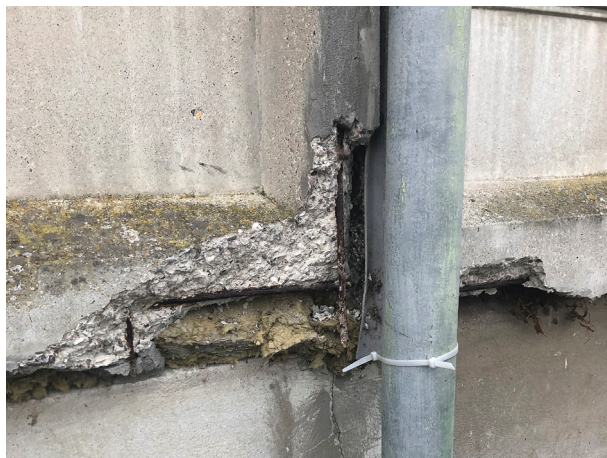
Afskalninger i betonkant ved sokkel
