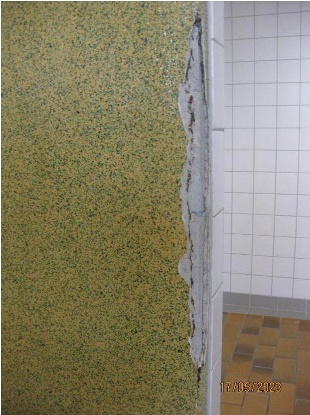
Flere omklædningsrum står med skadede vægge
