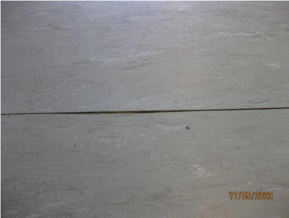
Slidt linoleum og defekt svejsning i køkken
