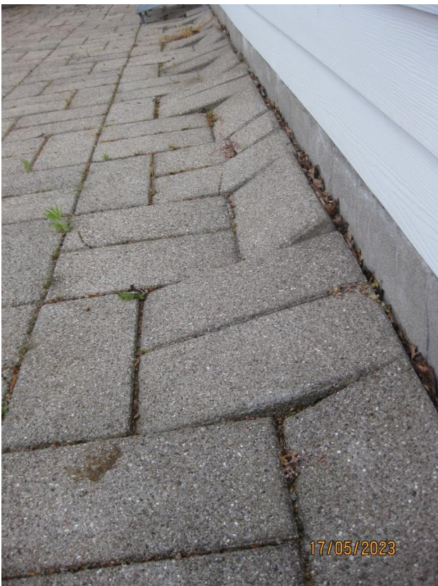
Kraftige sætninger på terrasse
