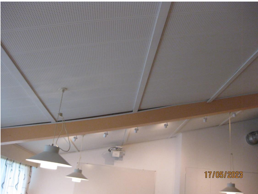
Ældre akustikloft med løse lister i cafeen
