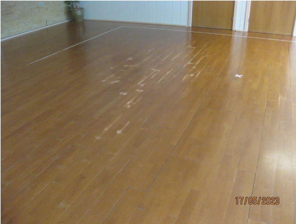
Vandskadedt gulv i Multirum på 1. sal
