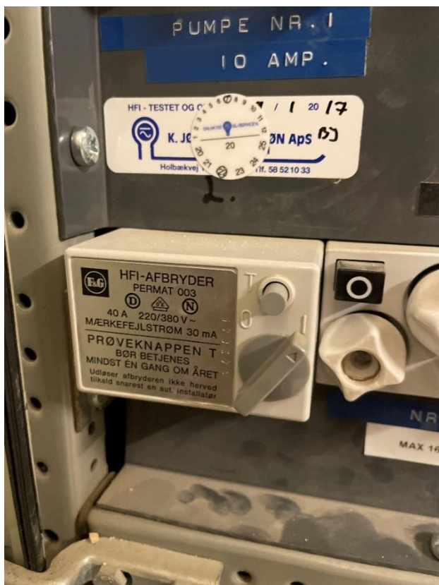
HFI relø som bør skiftes til HPFI
