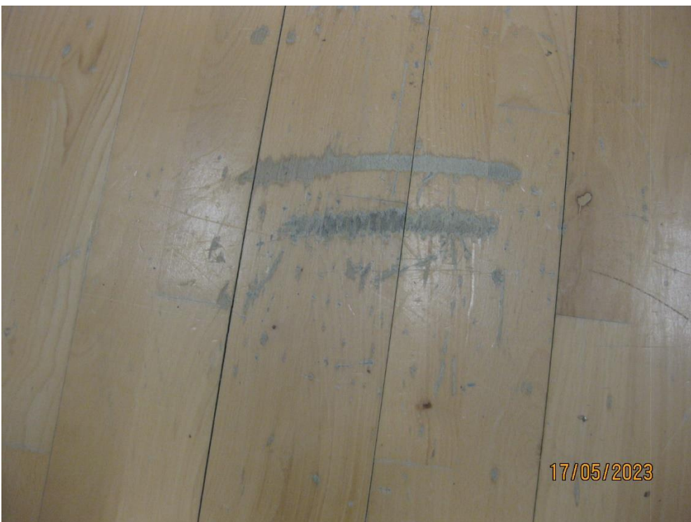
Halgulv partielt slidt ned til bart træ
