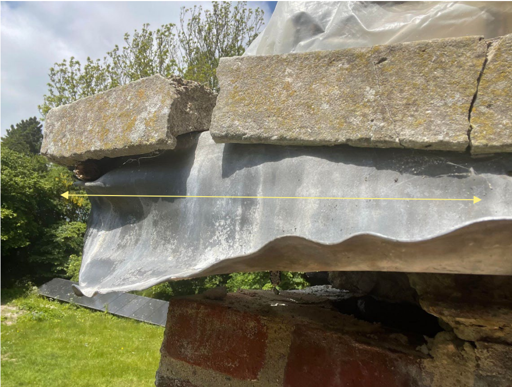
1 Hjørne, knækket af, revner i forbindelse med
