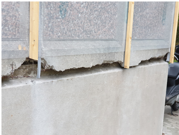
Afskallet, afbrækket beton
