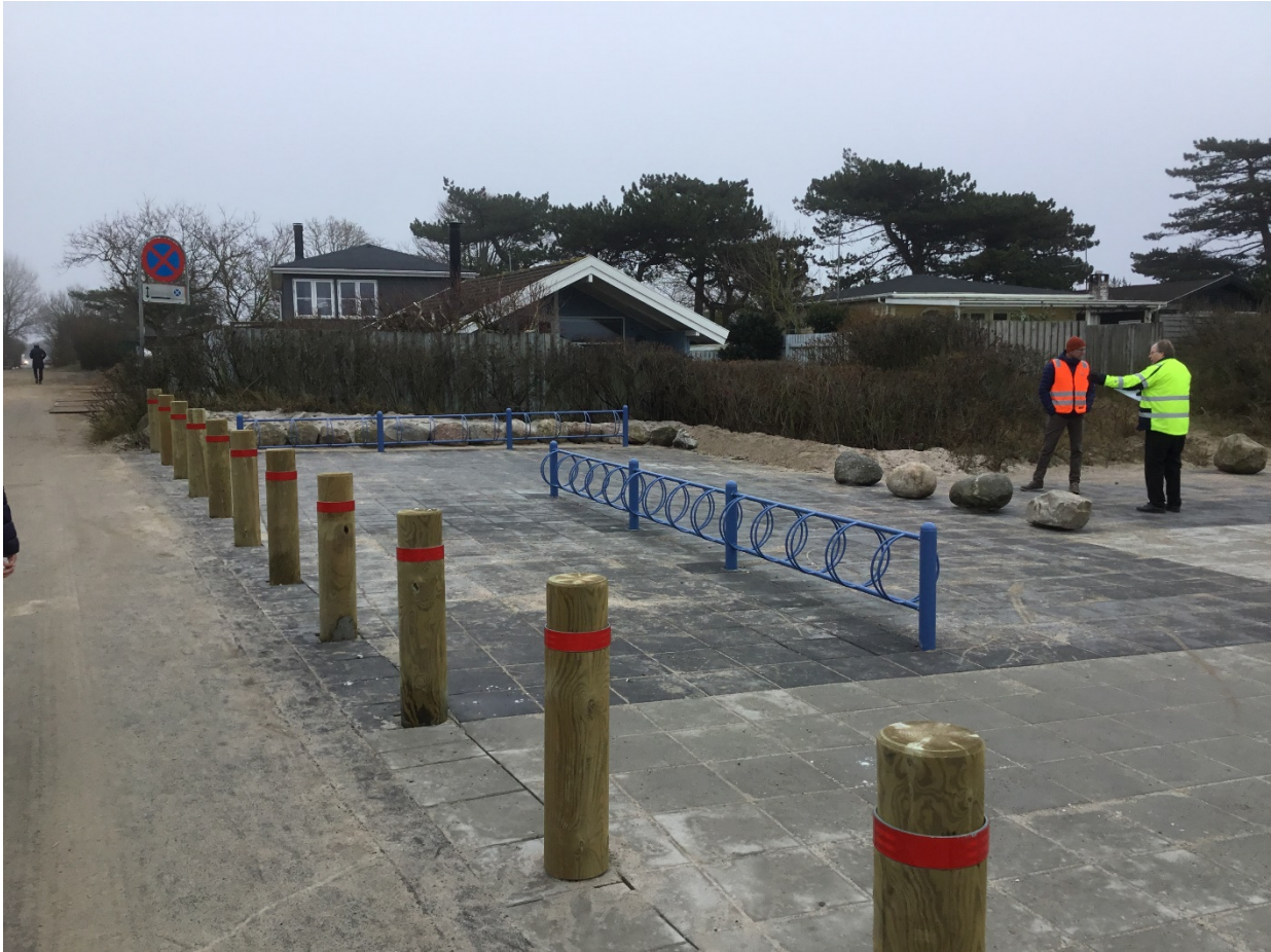
Figur 3: I retning mod Stillinge ses her den øvrige indretning af pladsen, der omgiver toiletbygningen på Stillinge Strand.
