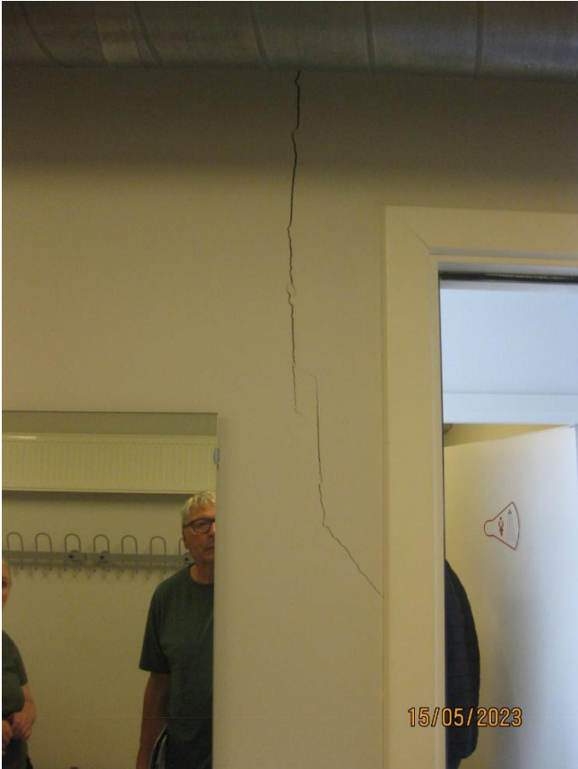
Der forekommer sætningsrevner i skillevægge til omklædningsrummene
