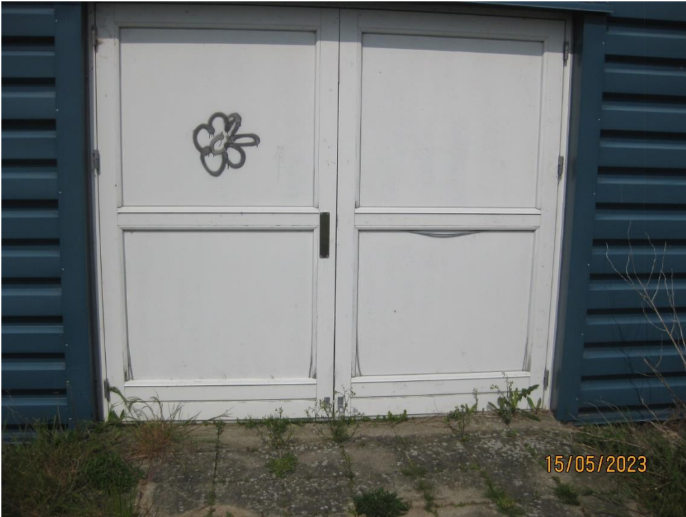
Yderdør fra hal trænger til snedkereftergang og maling
