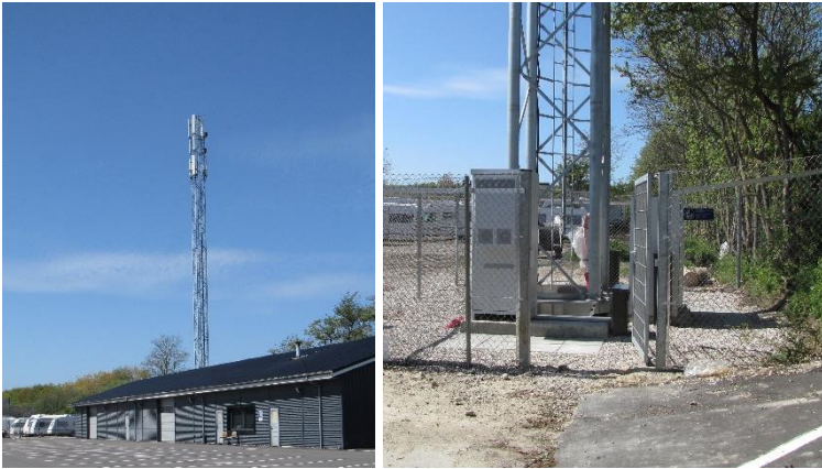
Eksisterende telemast placeret op mod den nordøstlige afgrænsning af lokalplanområdet med serviceadgang fra lokalplanområdet.
