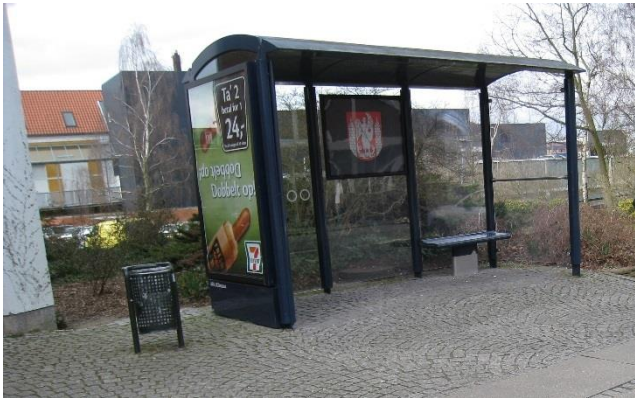
Figur 11: Læskærm ved busstoppested i Slagelse. Der mangler jævn belægning og ryg/armlæn på bænke.
