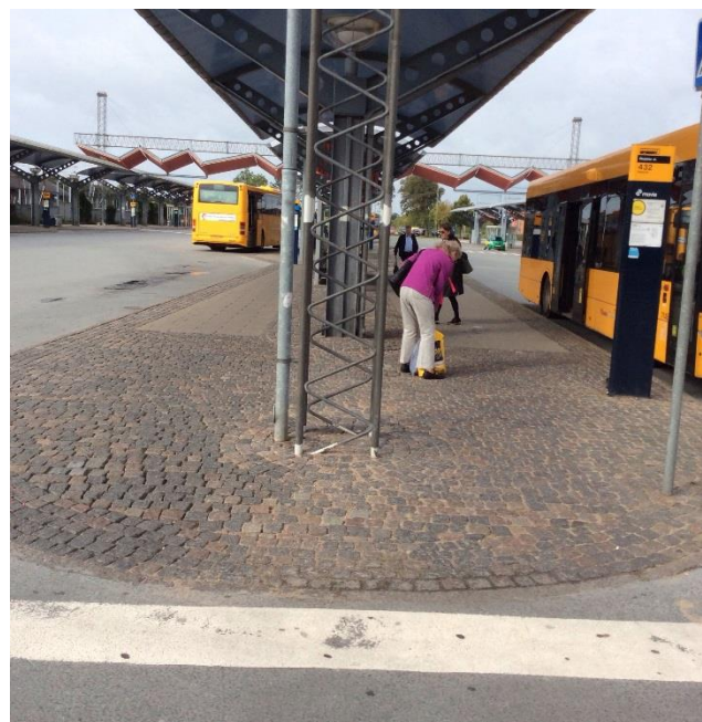
Foto 29: Adgang til bus-ø er anlagt i ujævne chaussésten.
