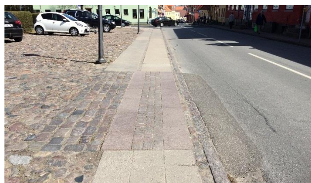
Foto 13: Brostensoverkørsel med gangbane i bordursten og savede og jetbrændte brosten i Skælskør
