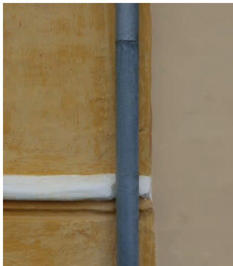
Kalket facademur (til venstre) og malet facademur (til højre).
