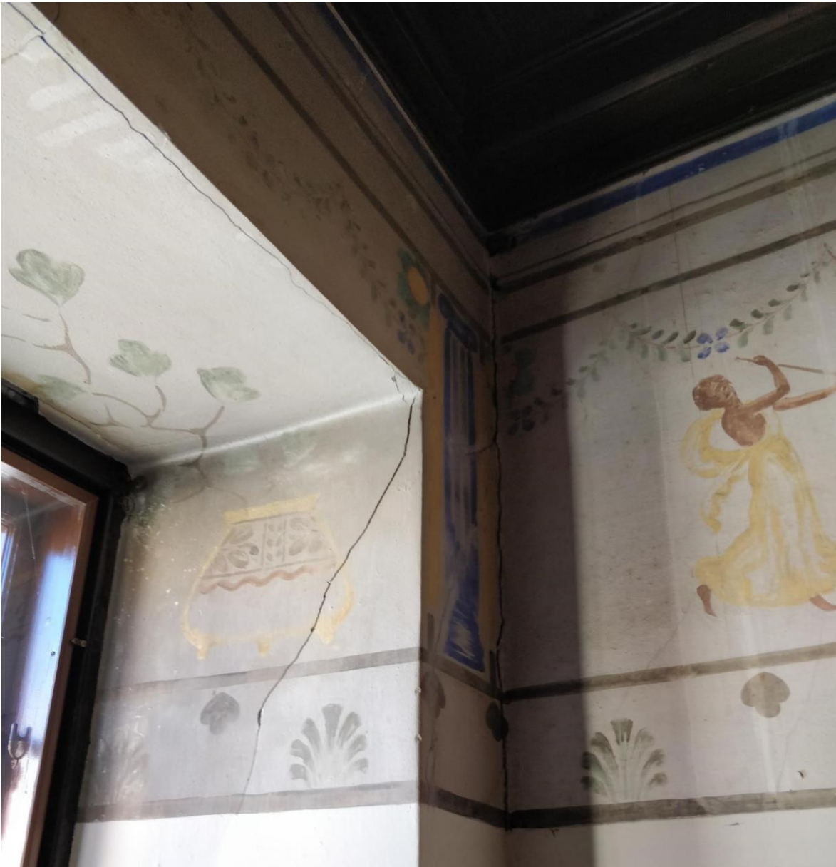
Murrevner. Et eksempel på sætningsrevne og ustabil puds i vindues niche.
