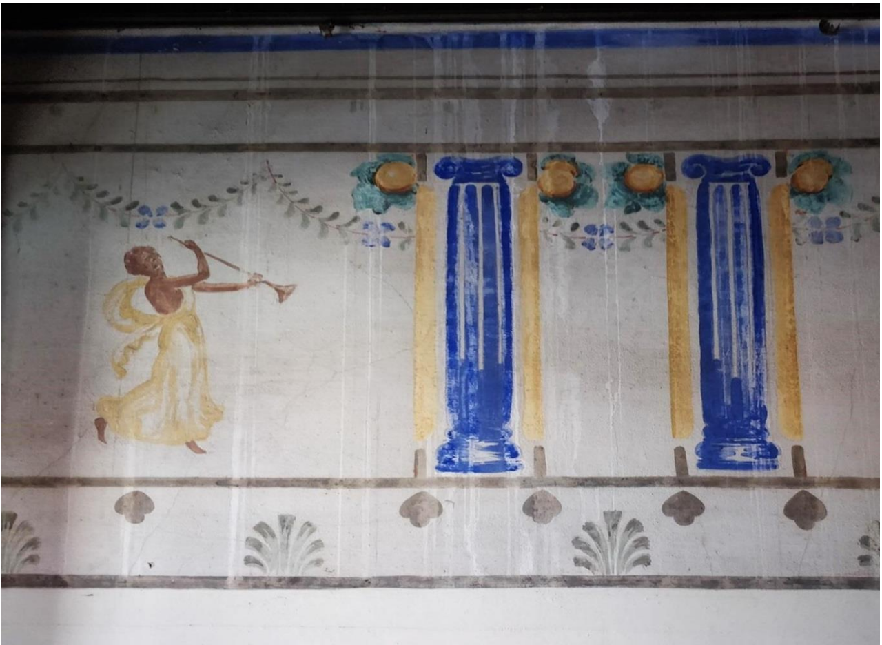
På et område af frisen har der tidligere været en vandskade, hvor der ses store ”løbere”.
