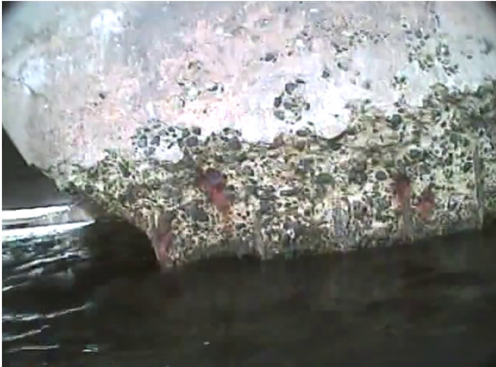
Foto 26: Erosion omkring daglig vande ved Oliepierens tilslutning til molen.
