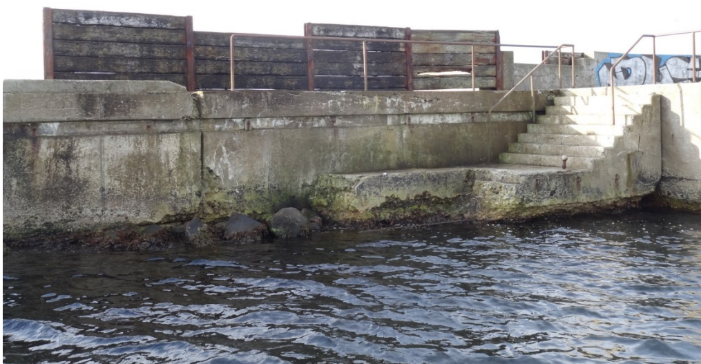
Foto 14: Eroderet trappesektion på indersiden af det sydlige molehoved.
