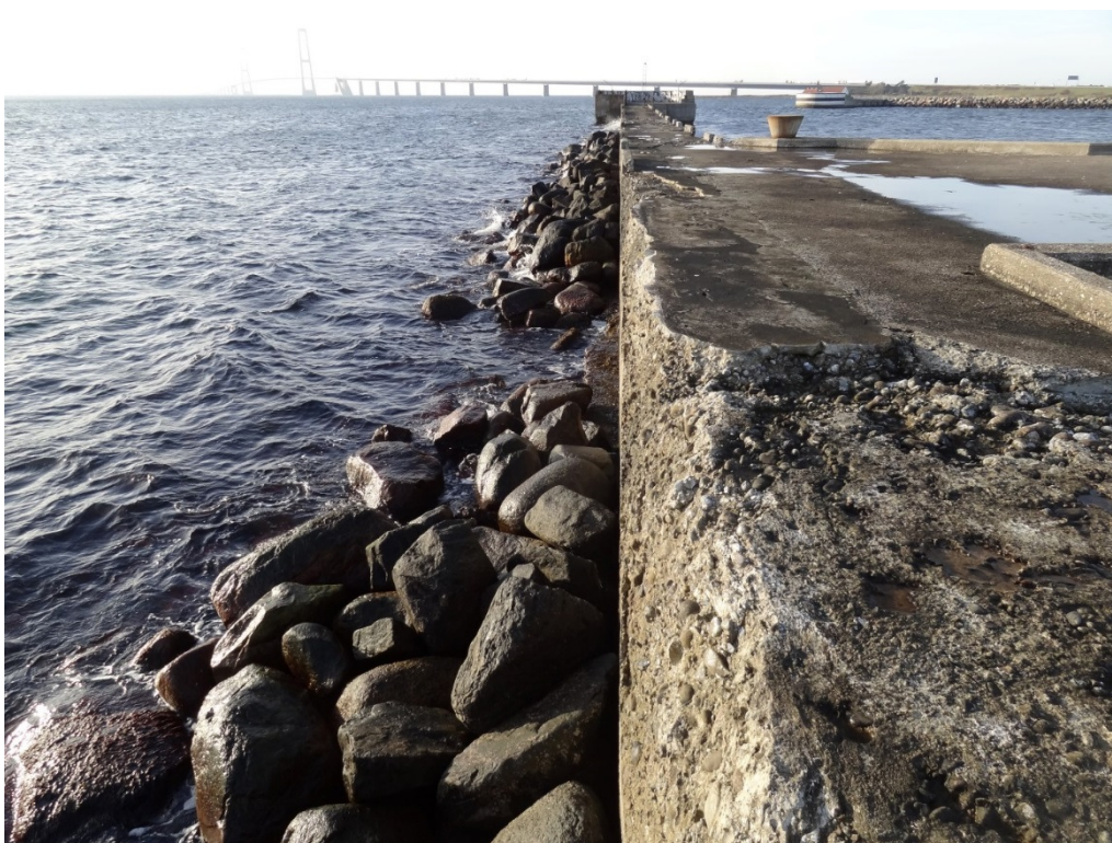
Foto 6: Manglende sten på ydersiden af den sydlige mole ved st. 360.
