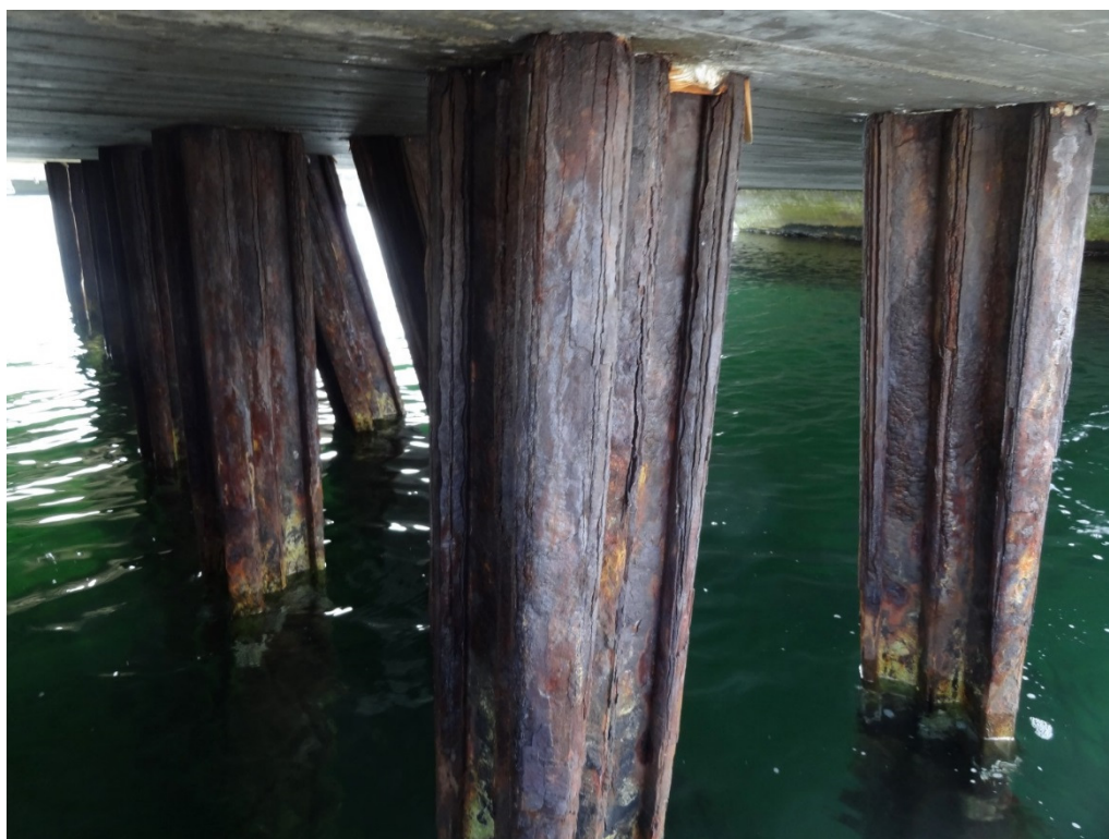
Foto 23: Korroderede stålpile over vand.
