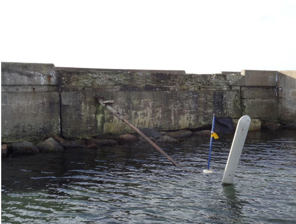
Foto 8: Beskadiget lygtepæl på den sydlige mole ved st. 300.
