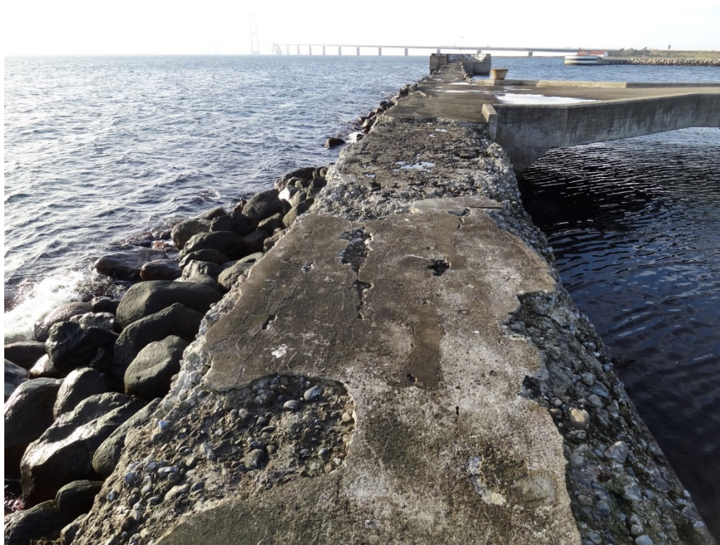
Foto 4: Eroderet betonoverbygning på den sydlige mole ved st. 360.
