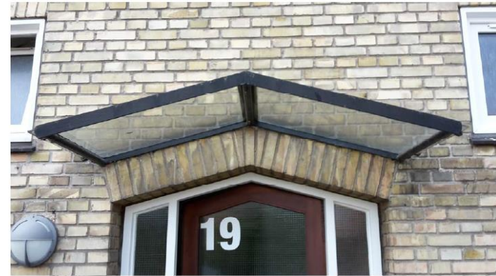
Foto 5: Opgangsdør under glasbaldakin. Dørpartier fremstår flotte og i god stand
