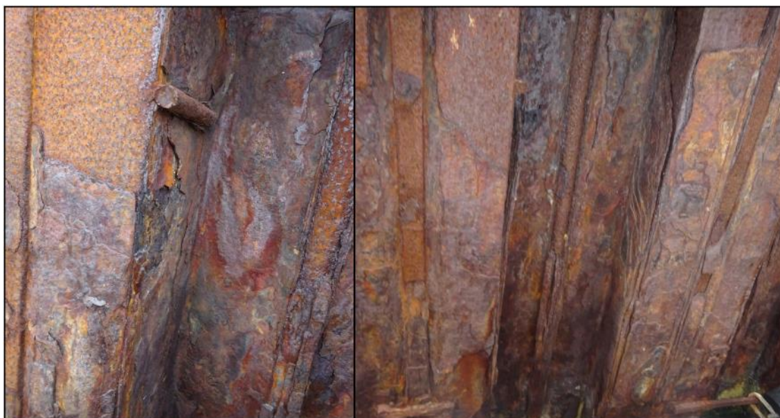
Figur 26: Korrosion af væggen, over vandspejl.
