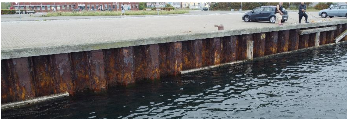
Figur 7: Strækning med afviserværk i ringe stand.
