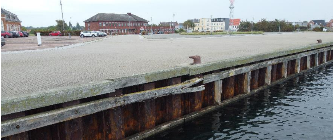
Figur 9: Beskadigelse af løsholt samt hammer.
