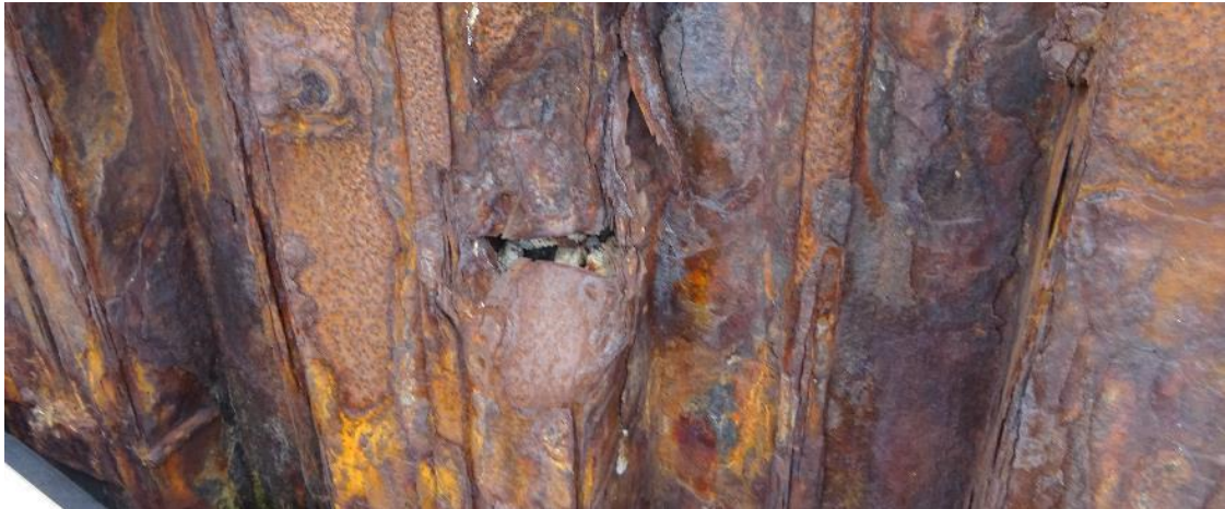
Figur 23: Påsejlingskade på spunsvæg.
