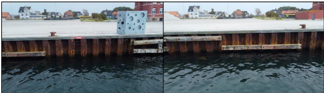
Figur 25: Beskadigelse af løsholt samt hammer.
