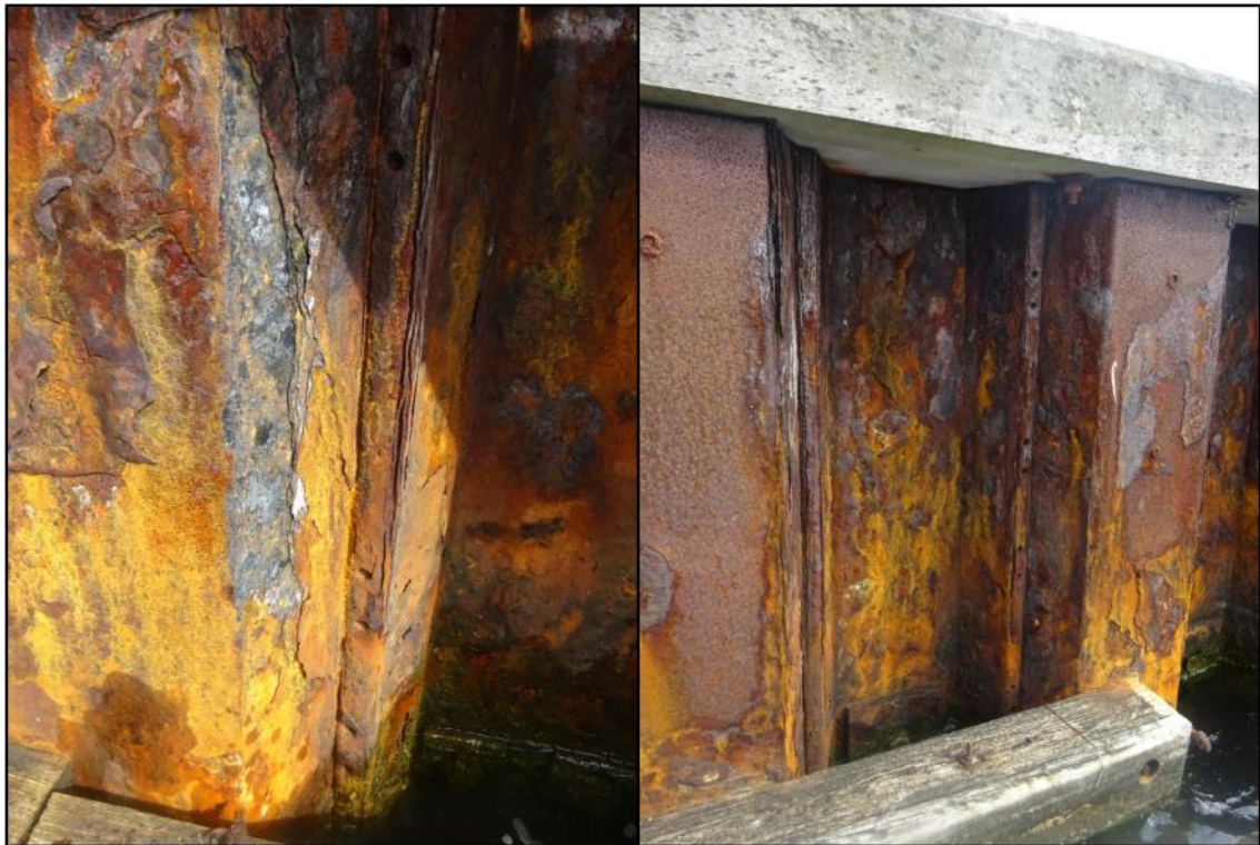
Figur 10: Kraftig korrosion af spunsvæg, særlig omkring vandspejl.
