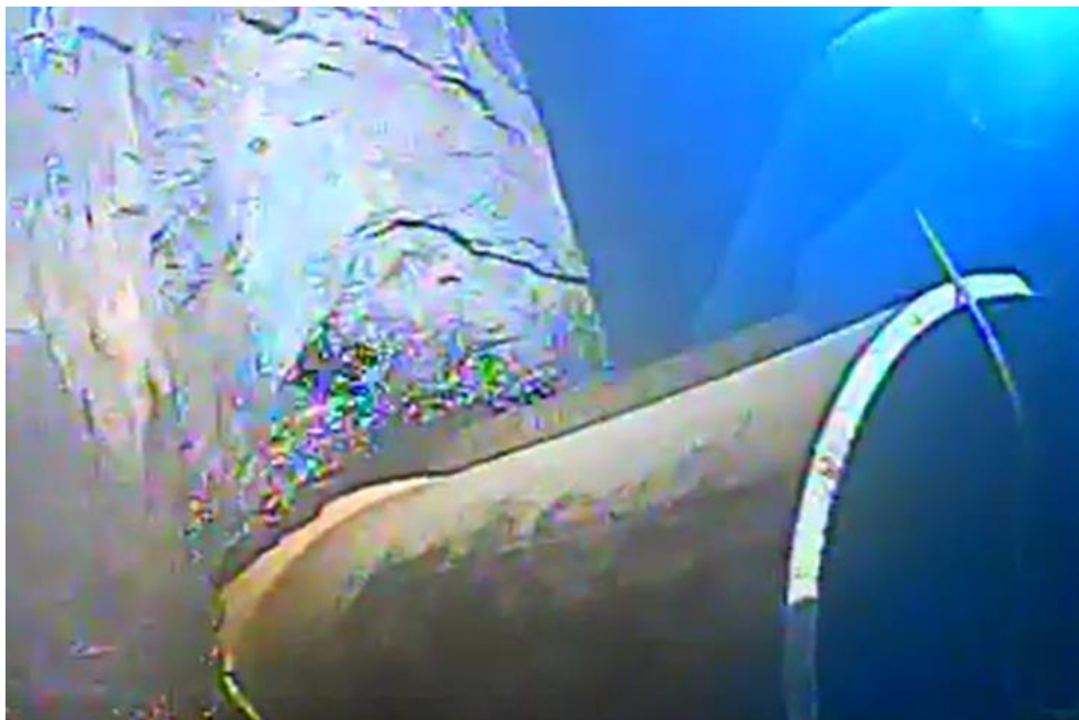
Figur 24: Utæthed langs periferi af udløbsrør.
