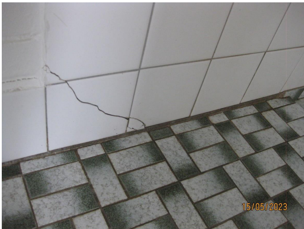
Defekte fliser i bruserum
