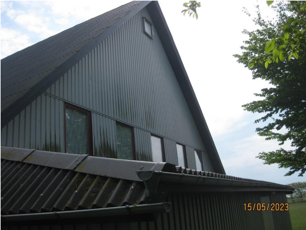
Facadebeklædning mod nord er tilsmudset af algebegrøning.
