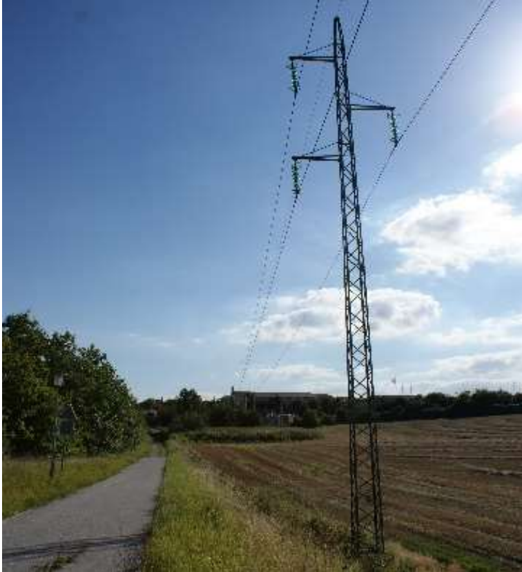
Eksisterende 50 KV luftledning som udgår fra transformestationen i baggrunden af billedet.
