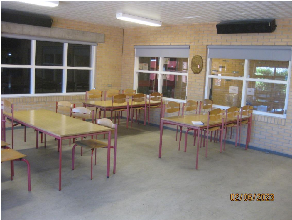
Slidt og skadet linoleumsgulv i cafeteria
