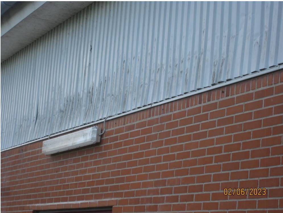
Bulede og skadede metalprofilplader mod boldbanen
