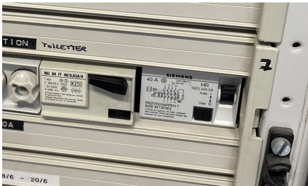
HFI relæer som bør skiftes til HPFI relæer
