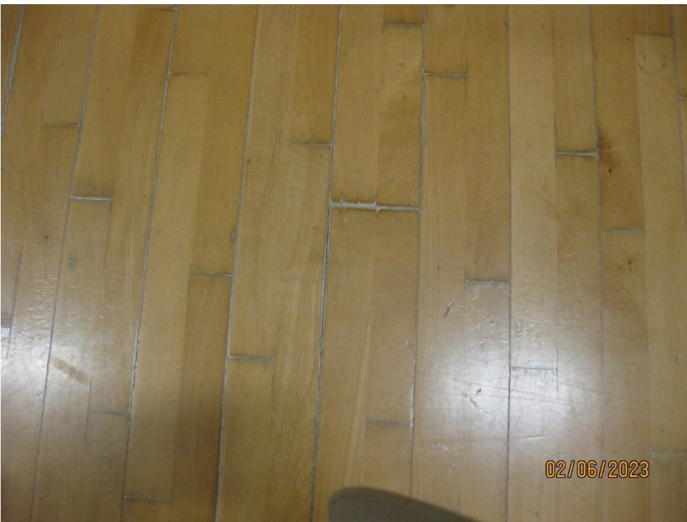
Gulv viser tegn på vandskader
