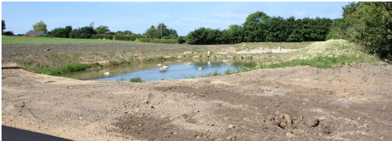
Eksisterende regnvandsbassin i delområde 3 mod vest med tilledning til eksisterende rende ved Grønlandsvej i Korsør.
