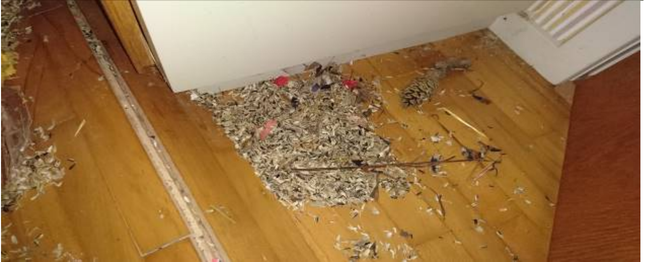
Bagerste værelse hvor der er anlagt rotterede og hvor gulvet har rejst sig.
