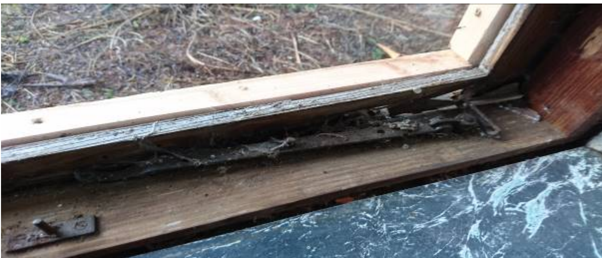
Vindue i bagerste værelse. Hvor der er utæthed i karmen til det fri.
