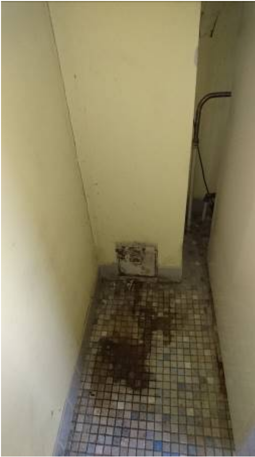
Bryggers med gasfyr og skorsten
