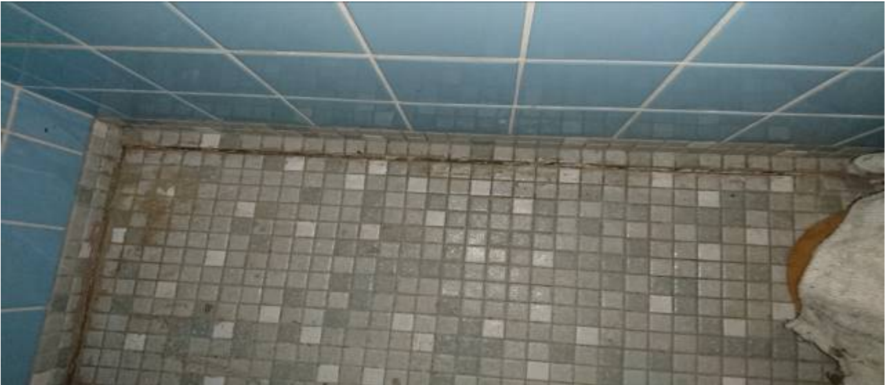
Toilet hvor væggen har skudt sig i forhold til gulv.
