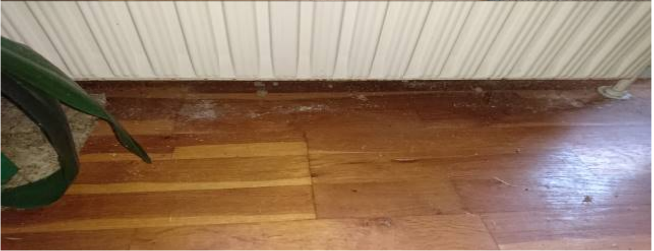
Skimmelvækst og rottespor i stue.
