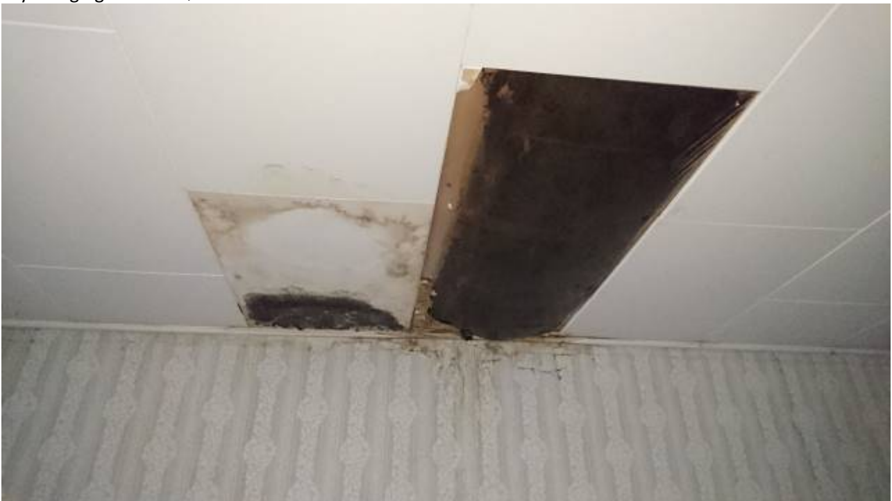
Manglende loftplade og svampevækst i værelse.
