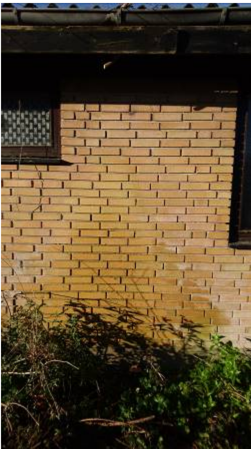
Opfugtet mur ved badeværelse
