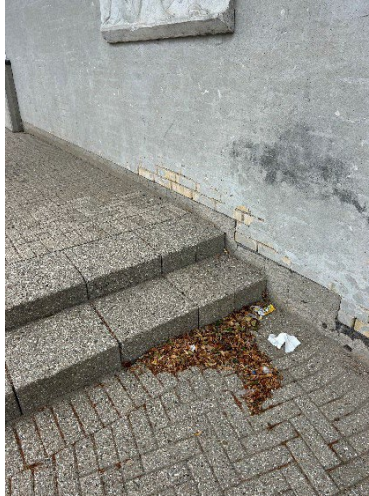
Sokkel og murværk som er porøst i overfladen, hvor der kan være indtrængen af fugt.
