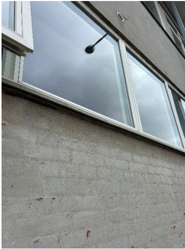
Der er mange revnedannelser i murværk, specielt ved vinduespartier.
