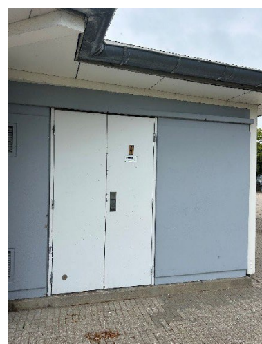
Højspændingsanlæg indbygget i den lave bygning. I et fremtidigt byggeri skal det undersøges om den kan flyttes, da den kan være generende at have i bygningen.
