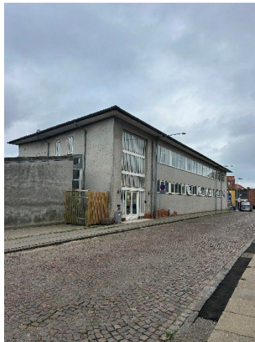
Murværk i Bernstengade opfugtet omkring terræn.
