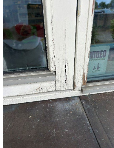
Træværk ved vinduesparti er defekt (råddent). Der er ikke meget restlevetid tilbage.
