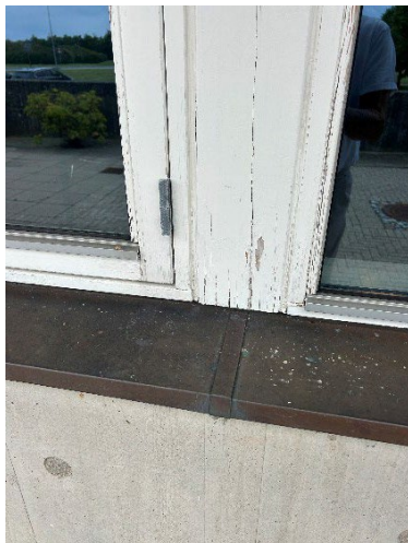
Træværk omkring vinduesparti som er meget blødt i strukturen. Dette er angrebet af råd og der er ikke restlevetid tilbage.
