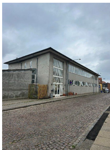
Facaden mod Bernstengade hvor murværk er meget opfugtet omkring terræn, hvilket fremgår ved visuel besigtigelse. Det kan medføre skimmelsvamp i konstruktionen.
