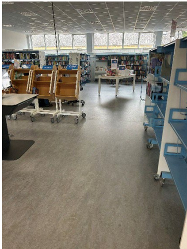
Nedhængt akustisk loft i afsnittet med Borgerservice.
