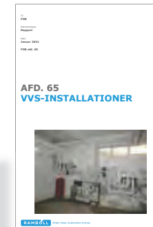
Installationsrapport Rambøll Januar 2021
