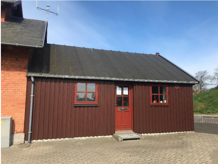
Bygning B. Facade mod syd. Bræddebeklædningen er angiveligt udført uden på en muret væg.
