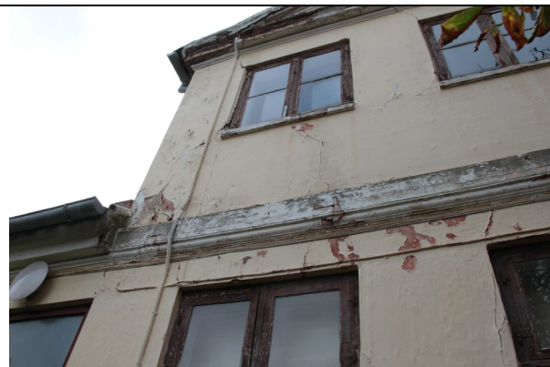
Sætningsskader i frontspids mod gård
