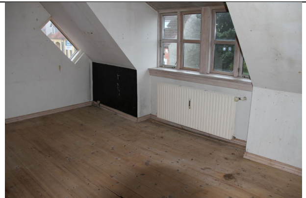
Kraftig nedbøjning i bjælkelag.
