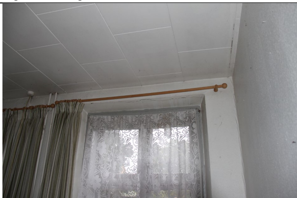
Sætningsskade indvendig på frontspids mod gård
