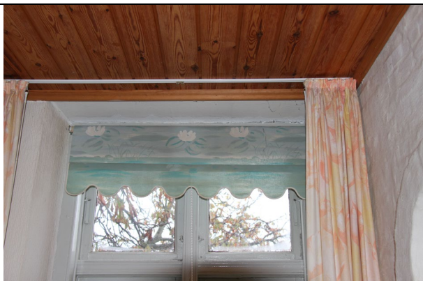
Sætningsskader og svækket murværk
