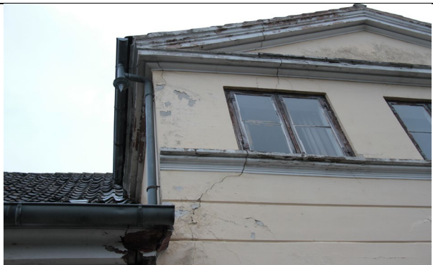
Sætningsrevne i frontspids hvor vægge flader ud og til side
