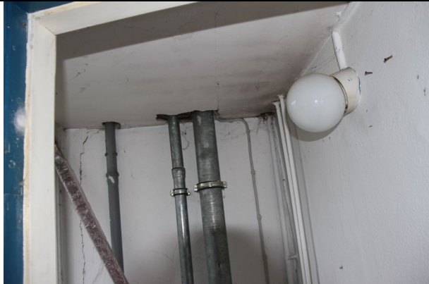
Sætningskade indvendig ved frontspids gård
