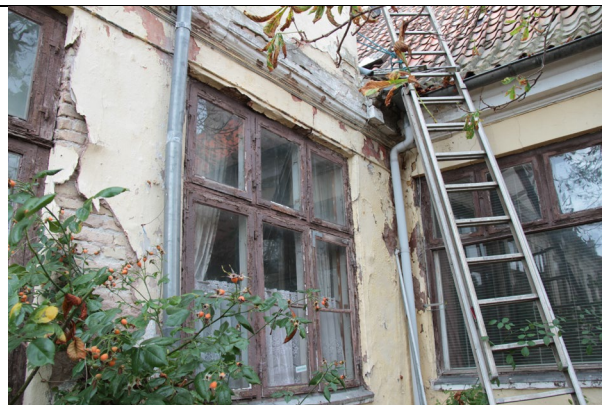
Facade mod gård nedbrudt inkl. vinduer
