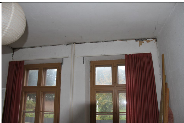
ingskader og svækket murværk
