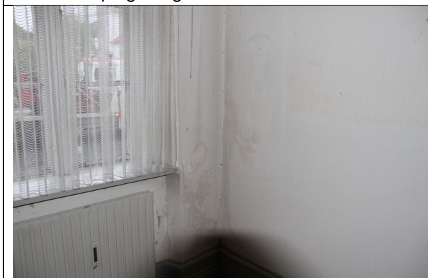
Fugtskader grundet utætte og nedbrudte facader
