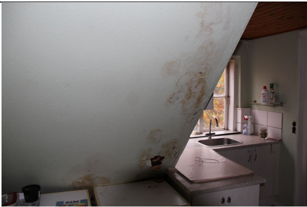
Skadet loft grundet nedbrudt takkonstruktion
