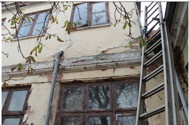
Sætningsskader i facade mod gård
