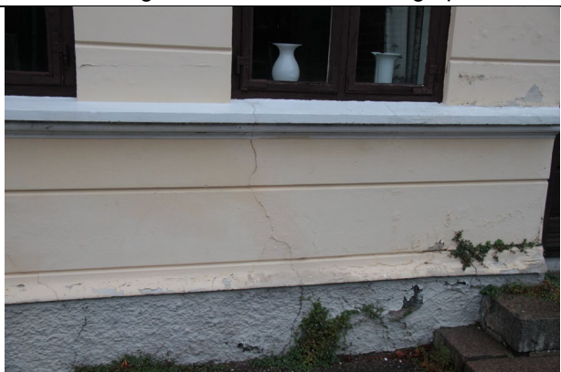
Flere sætningsrevner fra fundament og op i facade
