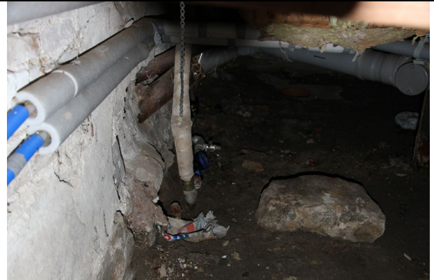
Krybekælder og fundament af sylsten
