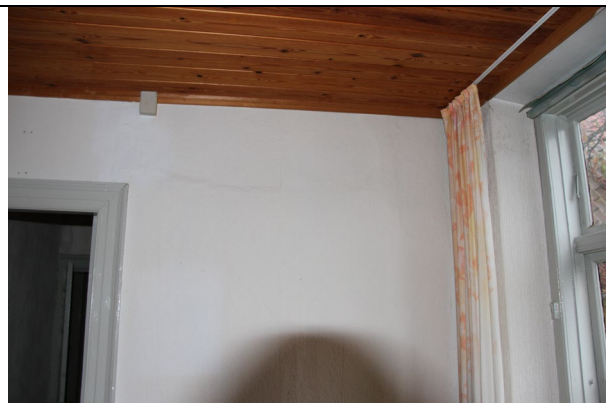
ingskader og svækket murværk
