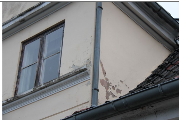
Flunker opfugtede og murværk nedbrudt
