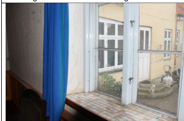
Fugtskader. Vindue i skel mod nabo, brand kan udvikles
