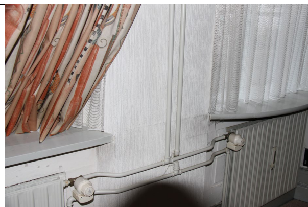
Gennemgående vandrette revner i murpiller
