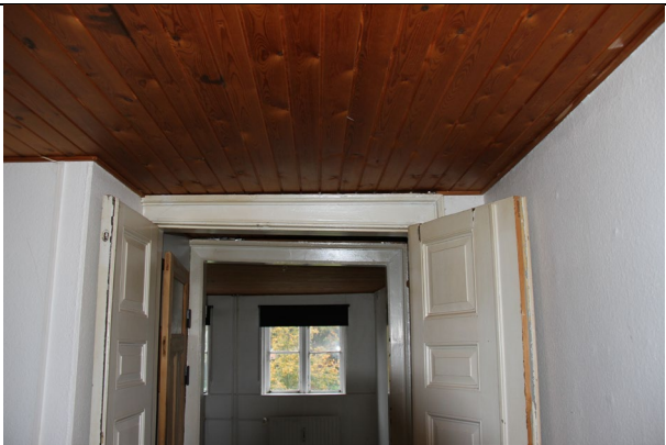
Skævhed grundet svigt i konstruktioner
