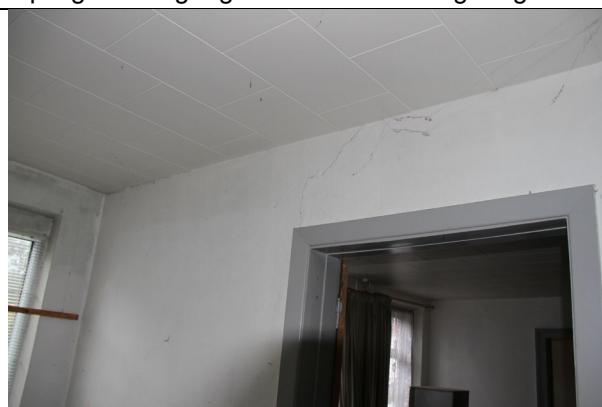
Sætningsskader i bærende vægge
