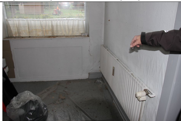
Hull i facade og sætningsskade
