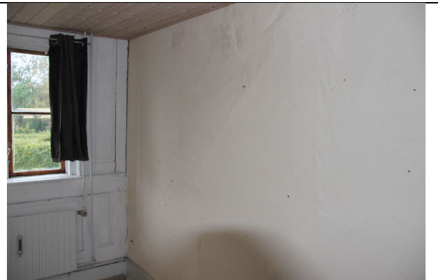
Skader på indvendig side af flunker
