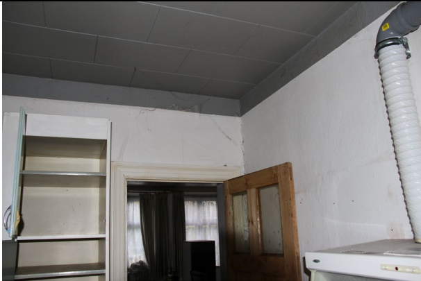
Sætningskade i skillevægge
