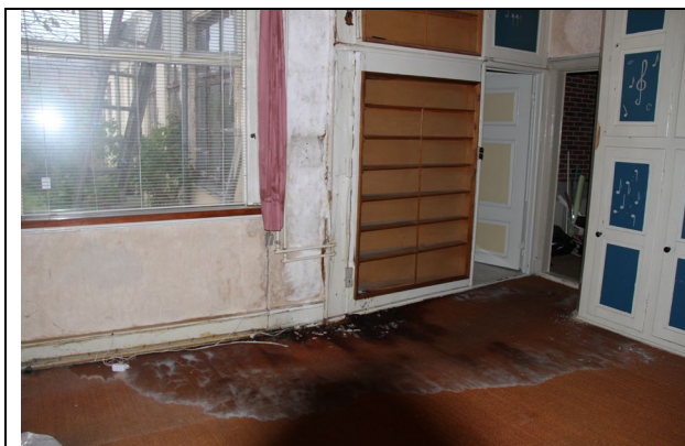
Skader grundet utæt / nedbrudt tagkonstruktion
