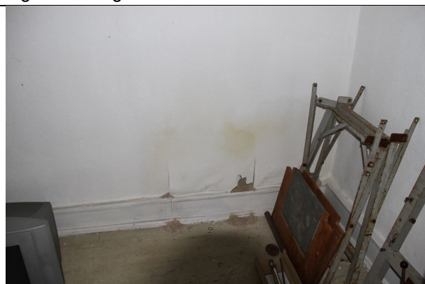
Fugtskader og nedbrudt indvendig væg
