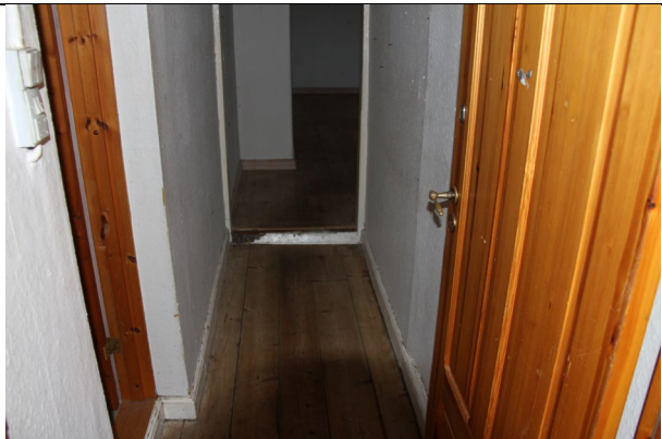
Gulve skæve grundet nedbøjning og svagt bjælkelag
