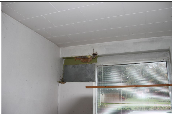
Nedbrudt bærende bjælke i facade
