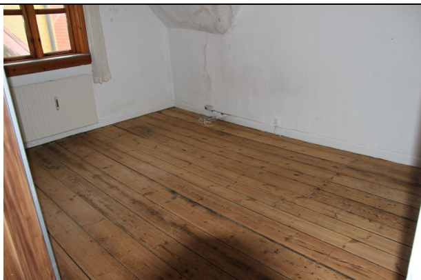
Skade grundet svigt i tagkonstruktion og bjælkelag er nedbøjet og svækket
