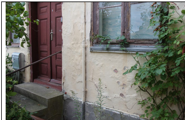
Murværk opfugtet og nedbrudt
