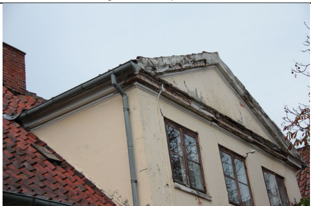
Frontspids i gård nedbrudt med mange skader
