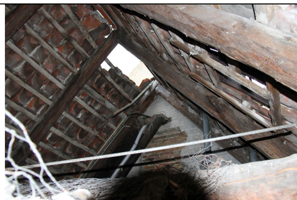
Spær, lægter og nedbrudt tagkonstruktion
