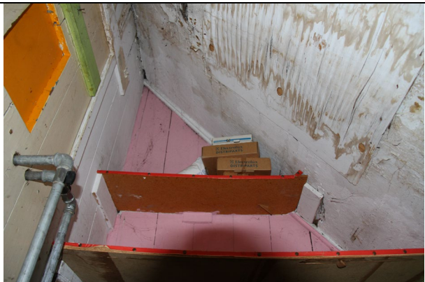
Skadet/nedbrudt loft grundet nedbrudt tag
