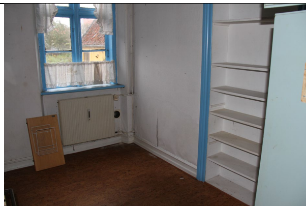
Nedbrudt bjælkelag skæve gulve samt fugt i vægge
