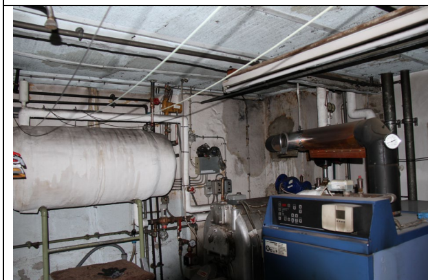
Vandindtrængen grundet utæt / nedbrudt tagkonstruktion
