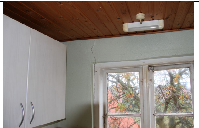
Sætningskade i frontspids mod gård
