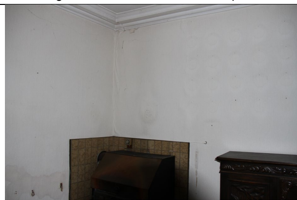
Indvendige skillevægge med sætningsskader
