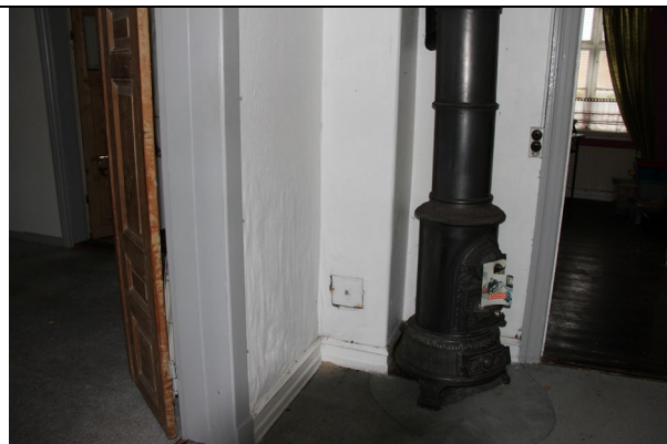
Opstigende fugt og nedbrudt indvendig væg
