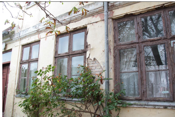
Skader på facade og vinduer mod gård
