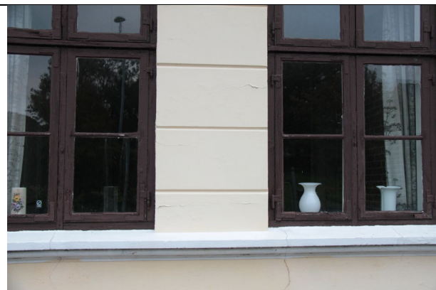
Gennemgående vandrette revner i murpiller
