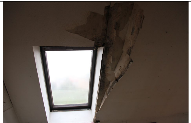
Skadet/nedbrudt loft grundet nedbrudt tag
