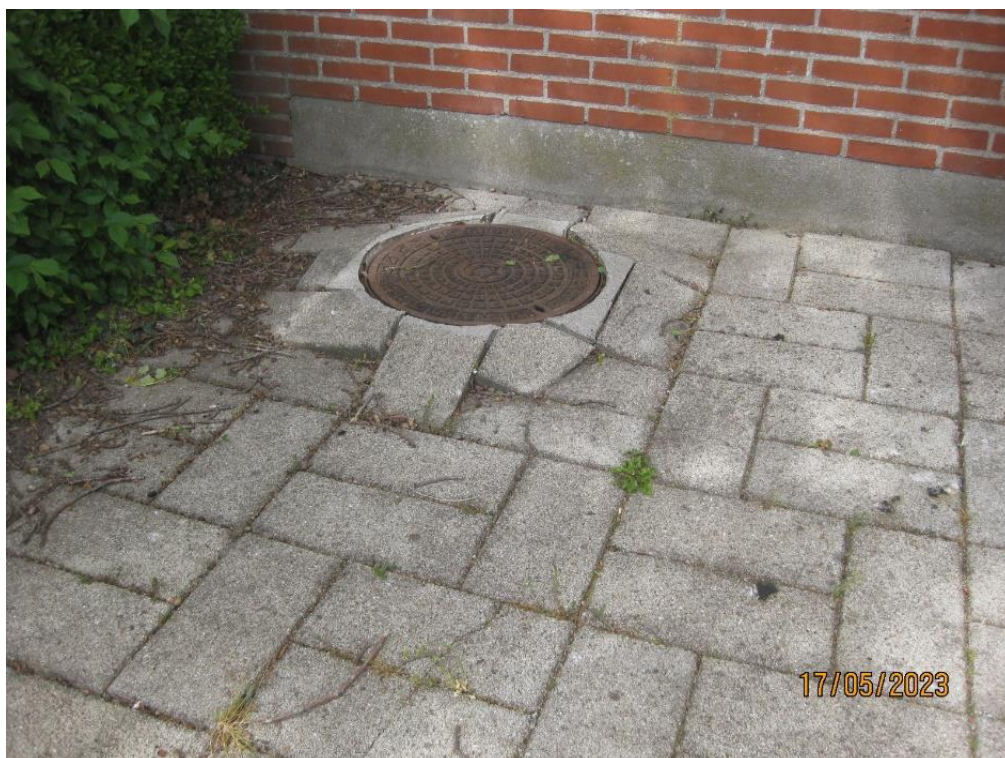
Krafig sænkning ud for kantine, og problem med tilstopning
