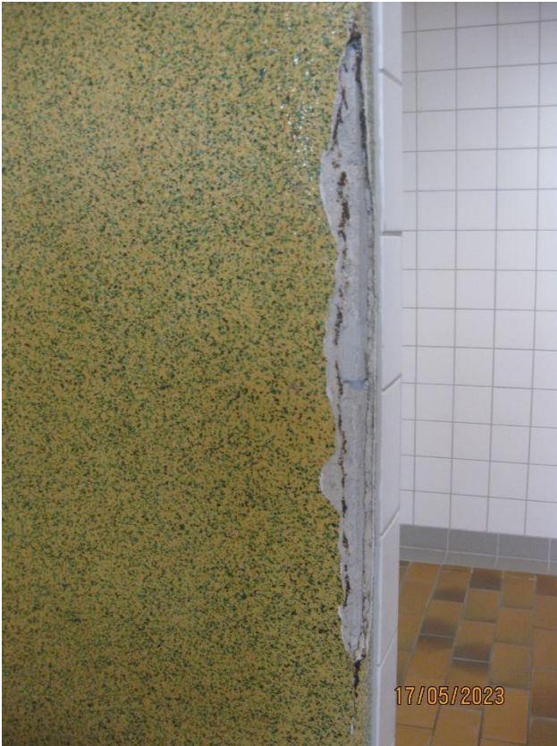
Flere omklædningsrum står med skadede vægge
