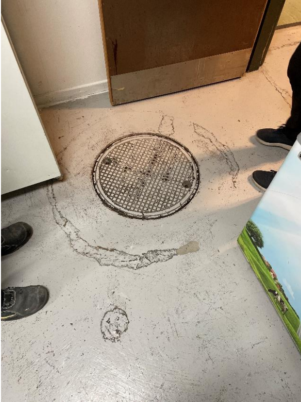
Pumpebrønde som bør forsynes med alarm
