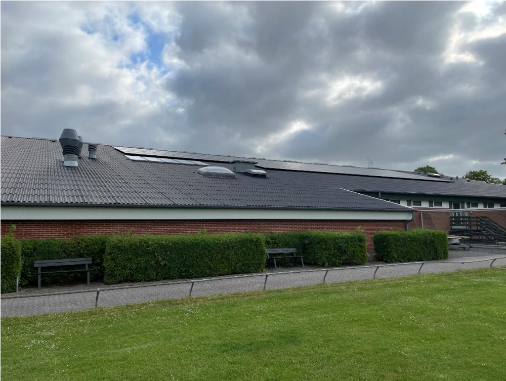
Hallens bølgeeternittag, hvor tagplader revner
