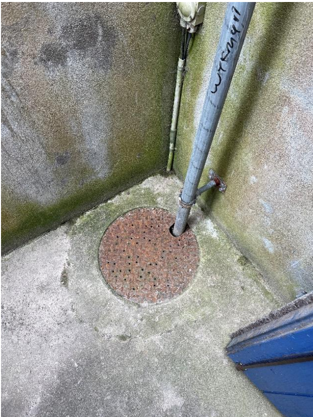
Pumpebrønd som bør forsynes med alarm og nyt dæksel, med bedre vandgennemtrængning
