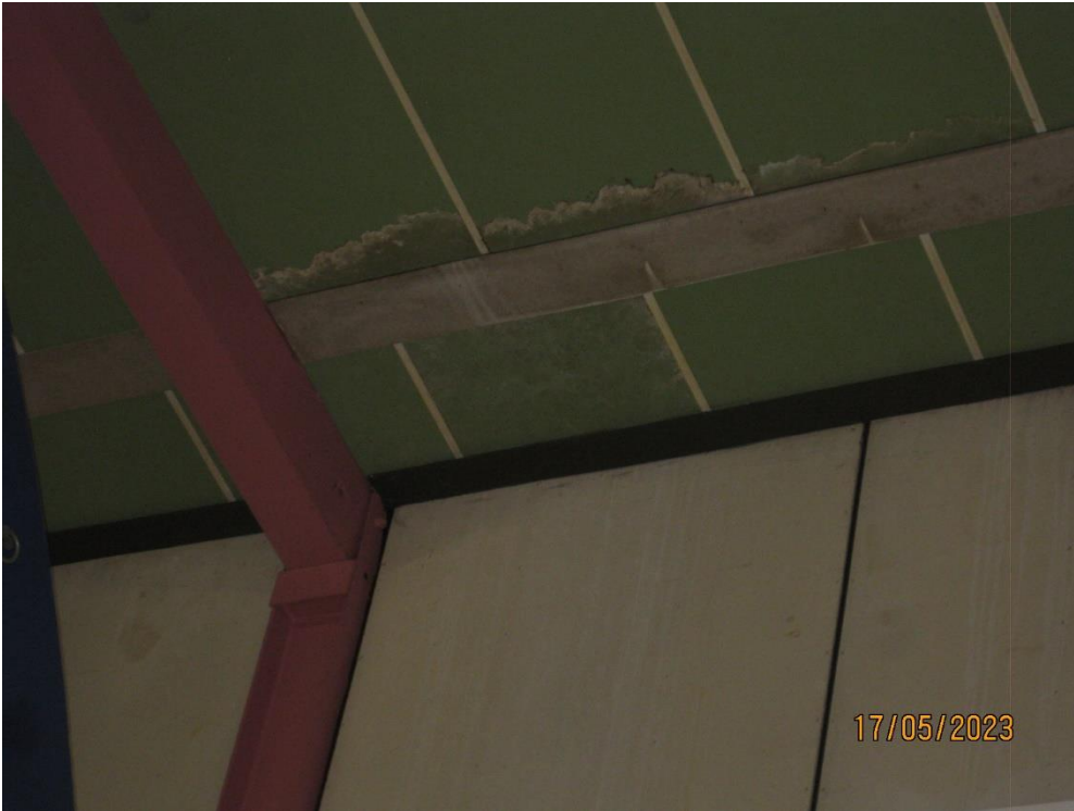
Skjolder på halloftet efter utætheder.
