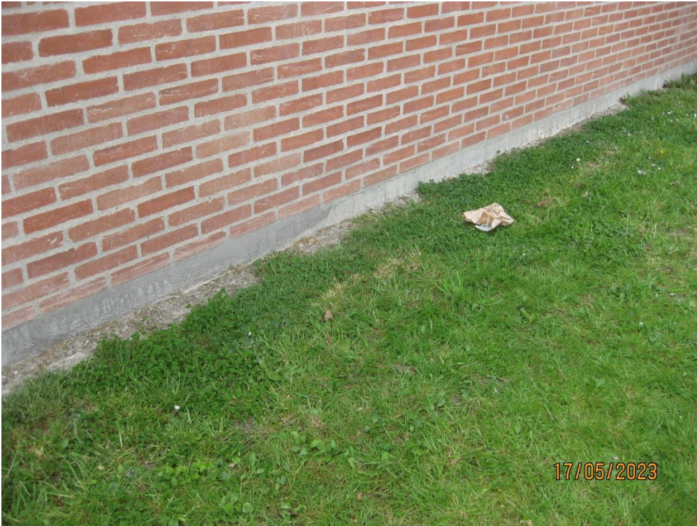
Murværk er blevet opfuget efter murbier. Sokkelpuds falder af flere steder langs nordside.
