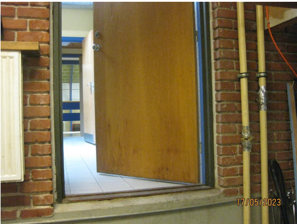
"Flugtvejsdør" i omklædning 6 til redskabsrum har èt trin ned på ca. 1m. Dette skal der findes en løsning på snarest, da det kan udgøre en personrisiko.
