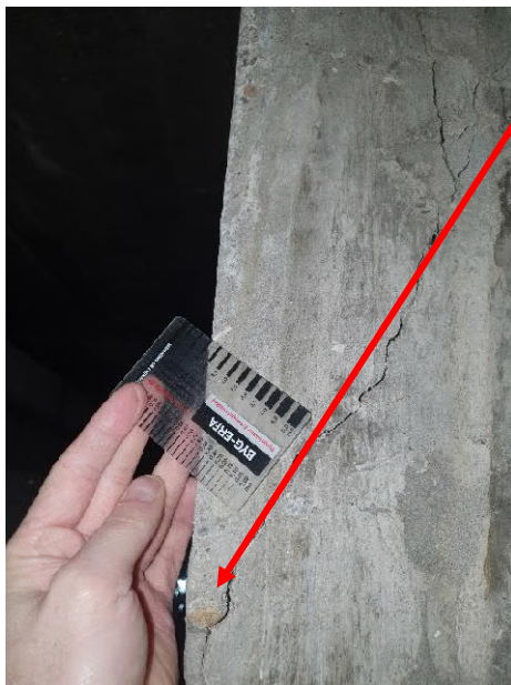
Pos 9 – tilstand 2023 Beton afsprængt ved bund af revne
