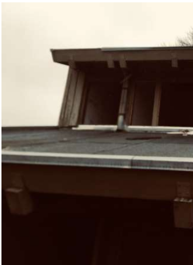
#11 Tagkonstruktion. Tagpap (er ikke prøvetaget, og kan fx indeholde asbest m.m.)
