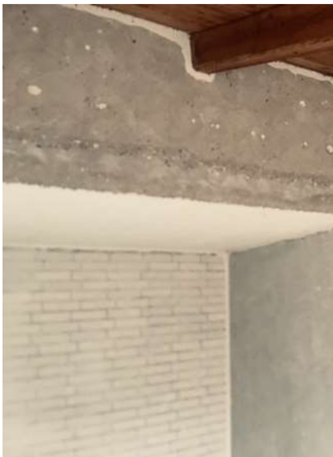
#5 Kælder. Fuger mellem murværk/beton og træbjælker
