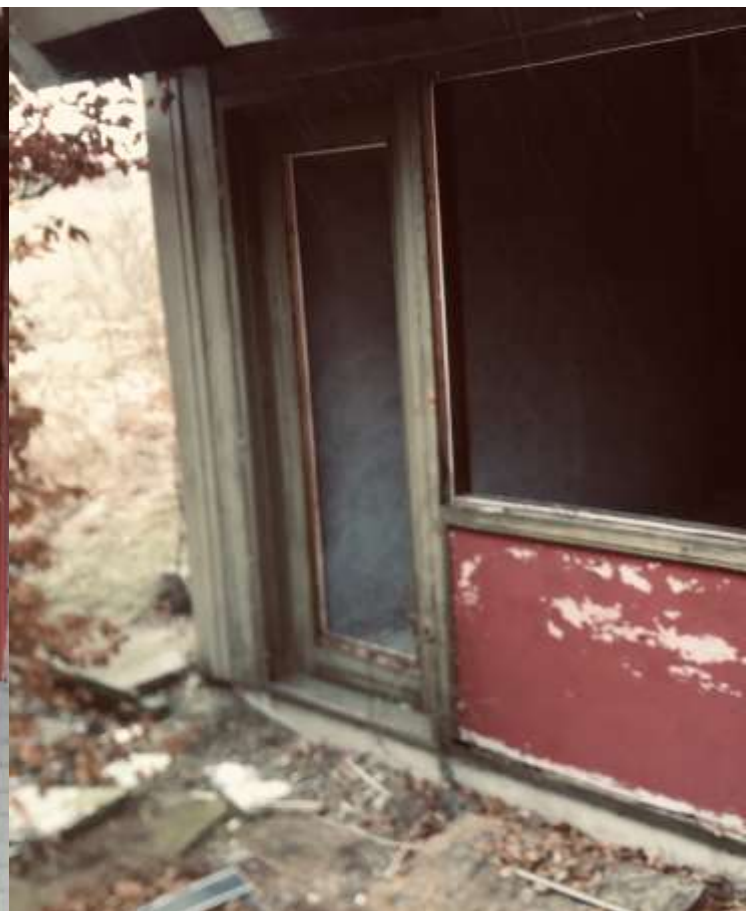
#2 Facade mod vandet, dør, og røde facadeplader (asbest). Ej saneret.
