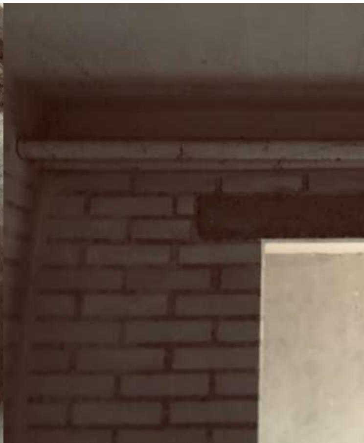
#4 Kælder. Varmepipe med asbest (ikke saneret)
