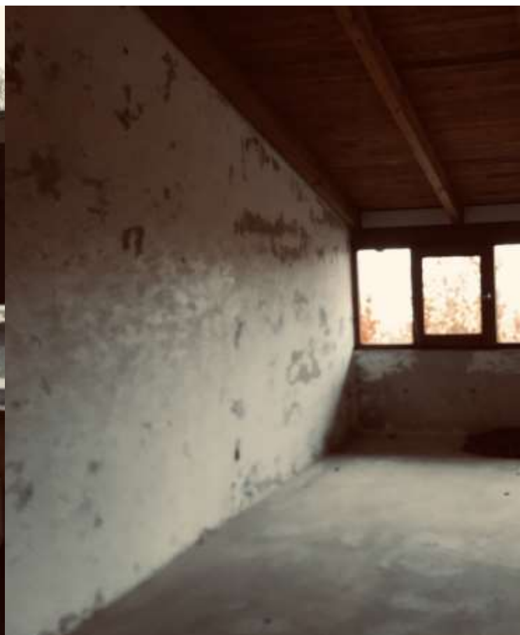
#12 Stue. Endevæg med hvid maling er ikke slebet af/saneret
