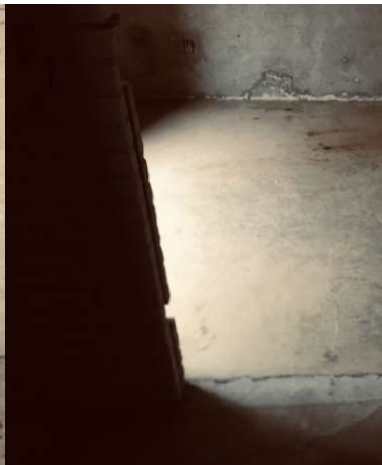
#8 Kælder. Malede overflader på gulv, som ikke er slebet af/saneret (ej prøvetaget)
