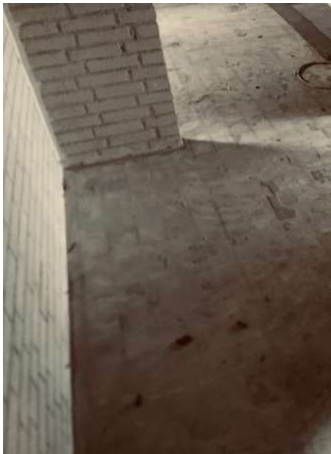
#3 Stue. Gulv med lim/klæber (ej saneret)
