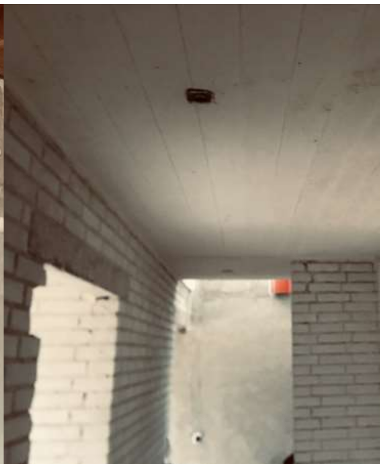
#6 Kælder. Malede overflader af betonloft, som ikke er slebet af/saneret
