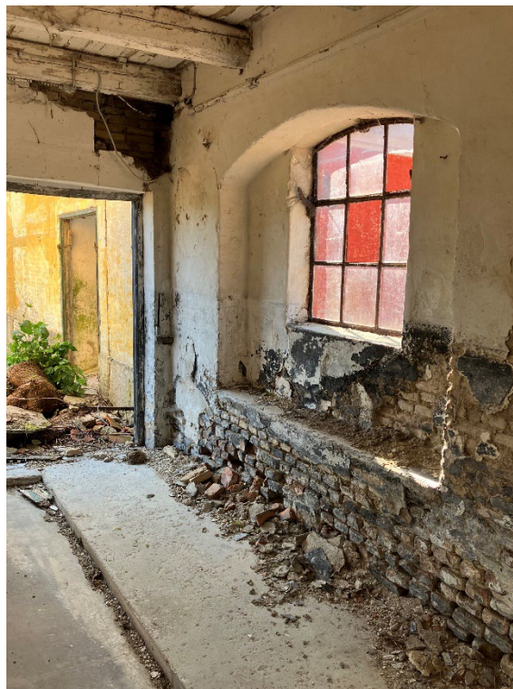
Afskallet murværk, indvendigt
