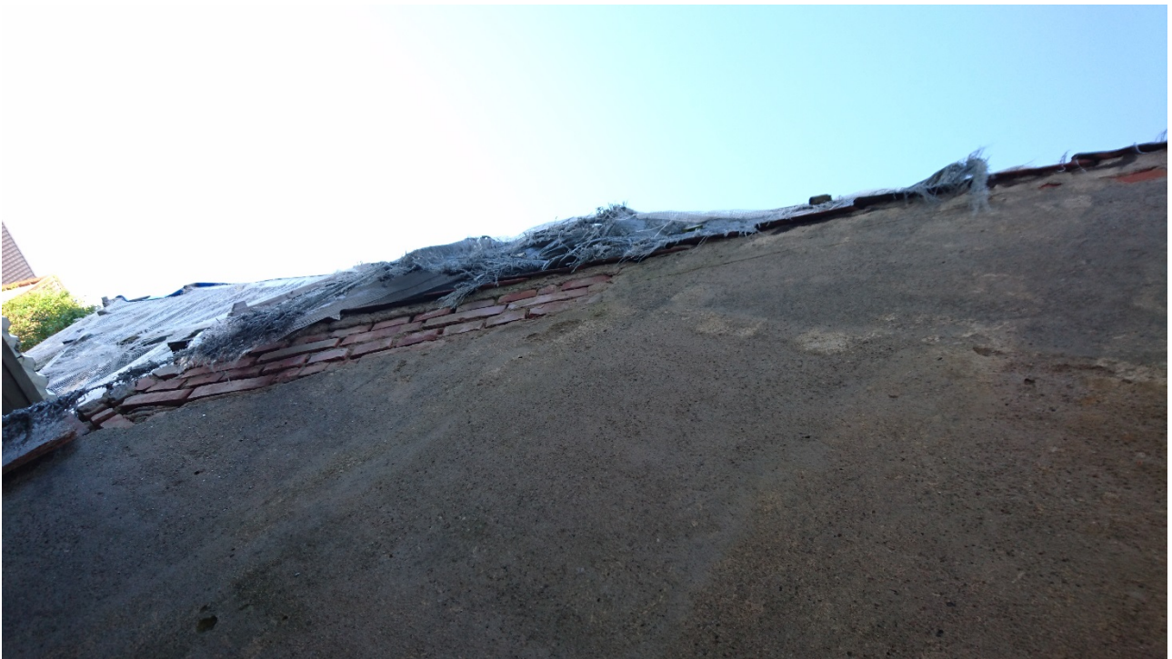
Løsrevet presenning og forvitring af fuger i brandmur
