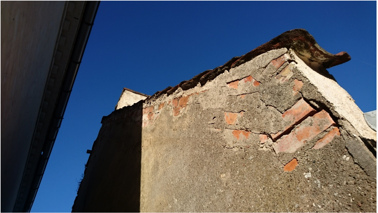
Forvitring af fuger i brandmur mod naboejendommen.
