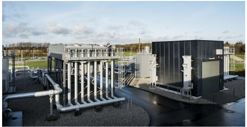
Kompressorbygning og fritstående køleenhed
