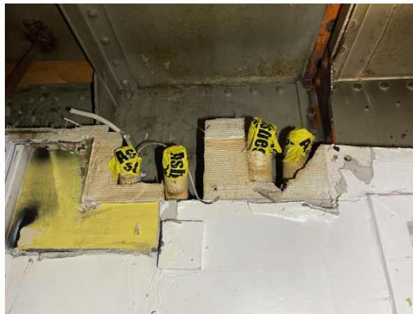
#26 Promenadedæk, rør forseglet med asbest tape
