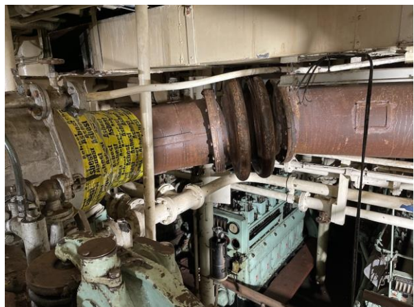
#6 Maskinrum, Udstødningsrør fra hovedmotor pakket i asbest tape
