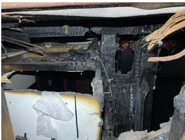
#23 Brandskadedet område ved trappe ned til spisesalon på mellemdæk
