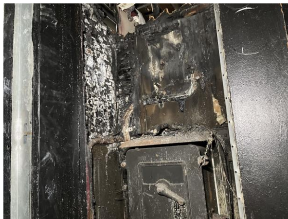
#24 Brandskadedet område ved trappe ned til spisesalon på mellemdæk
