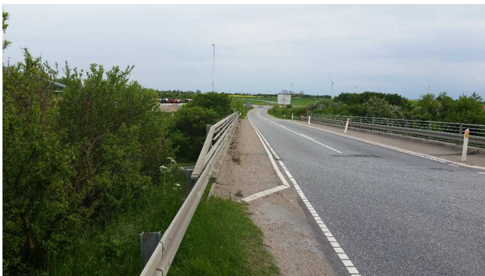
Billede fra den forventede placering af nyt kryds fra frakørselsrampe mod syd – Bemærk det høje broautoværn.
