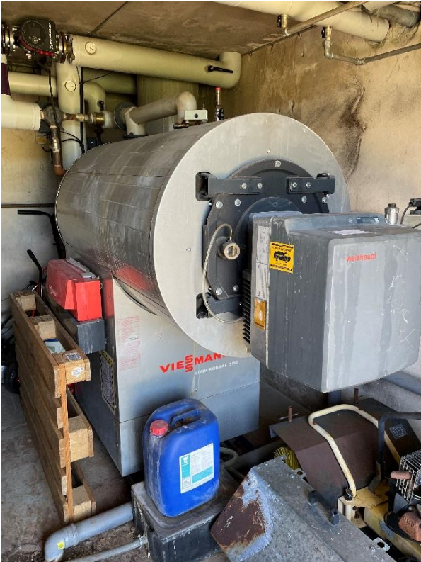
Gasfyr som forventes konverteret til fjernvarme i 2024
