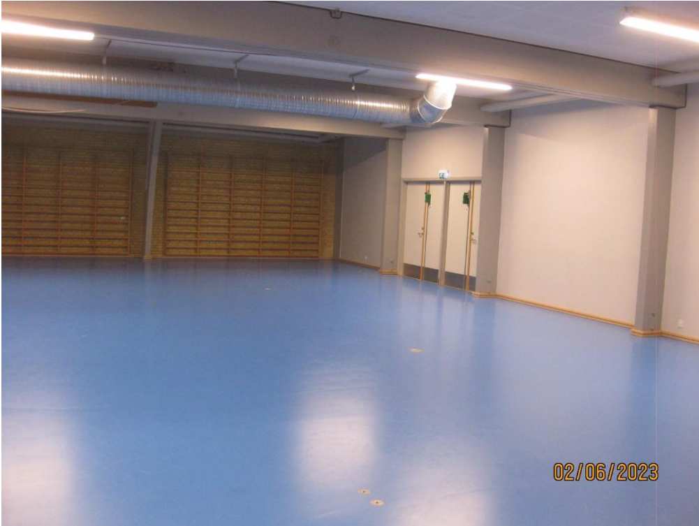
Gymnastiksal med dårlig akustik
