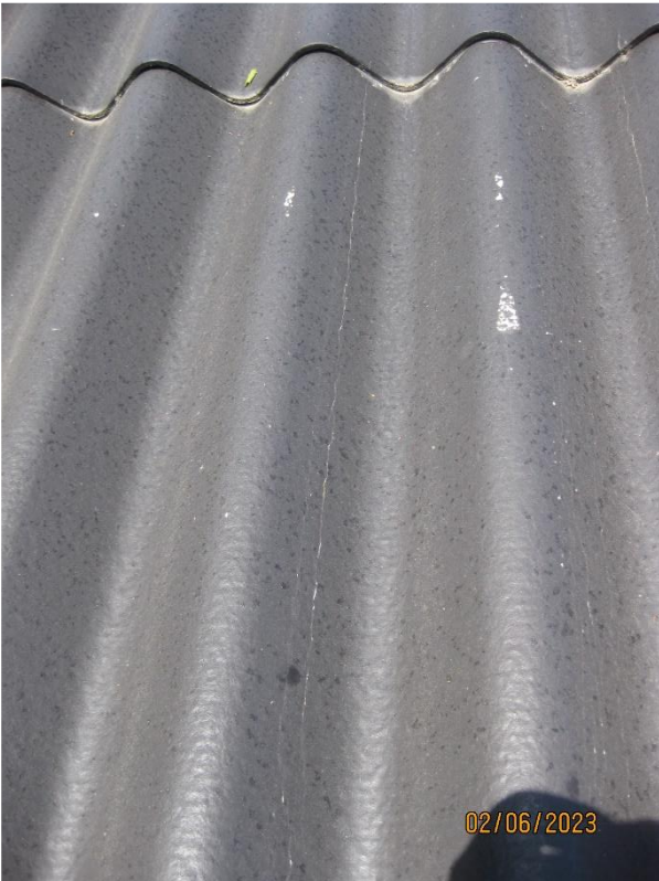
Revne i tagplade som bør udskiftes
