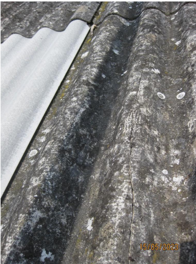
Revnet bølgeeternittag på varmecentralen.
