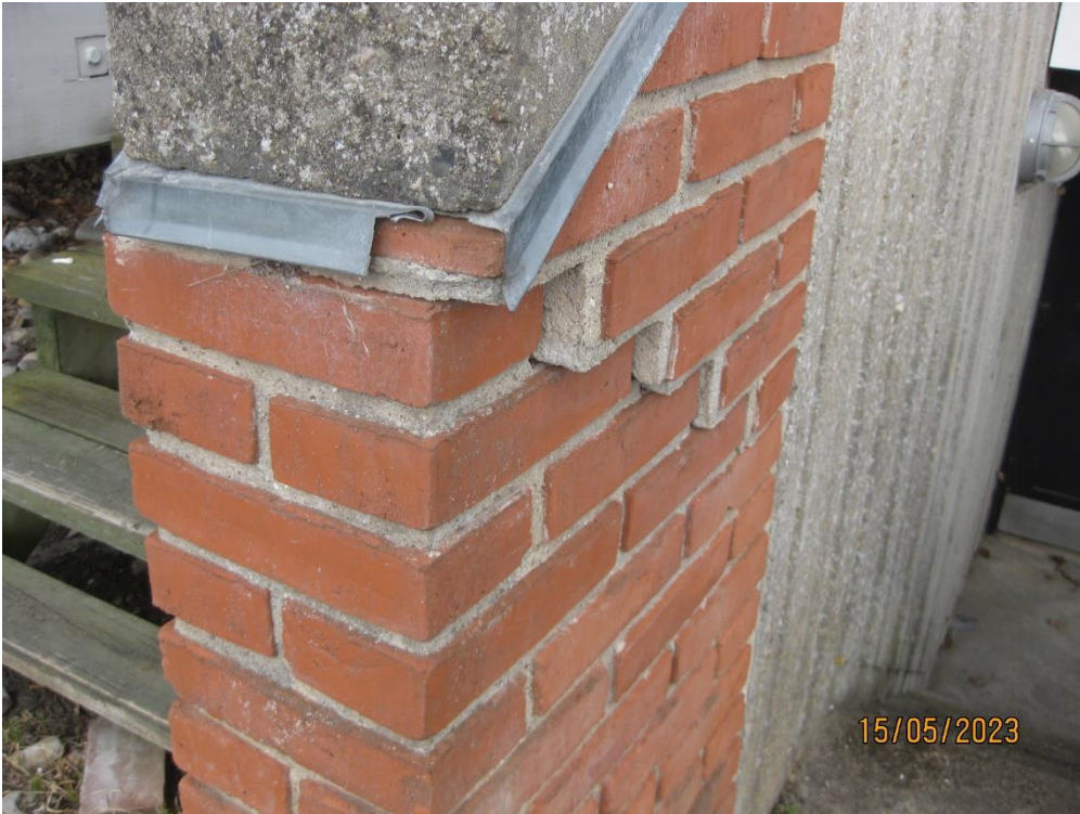
Støttemur skadet ved spillernedgang til omklædning
