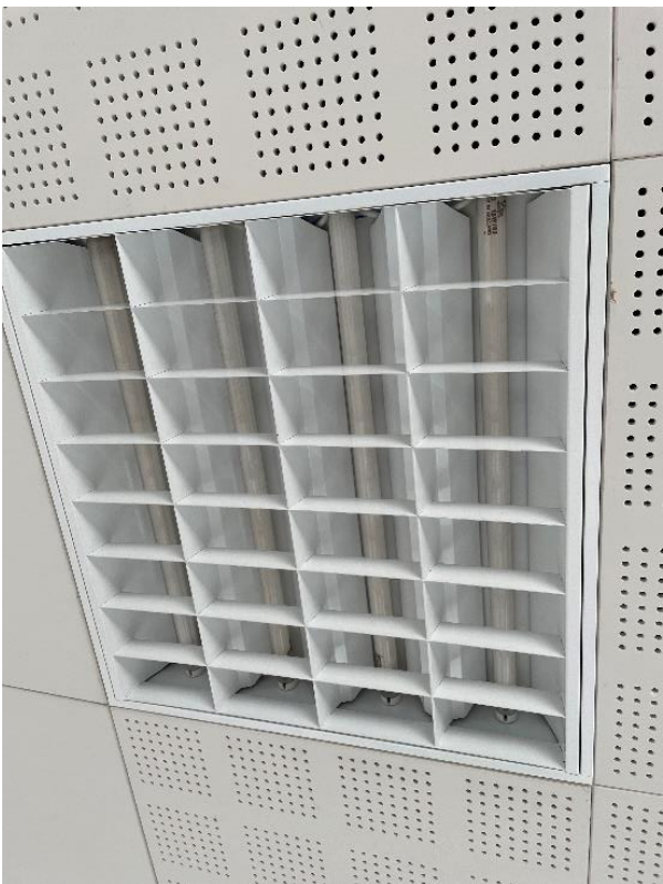
Armatyr som skal udskiftes til LED
