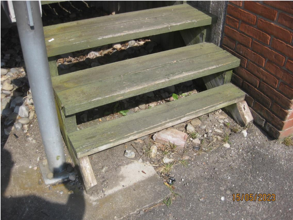
Nederste trin på terrassetrappe er defekt/mangler delvist
