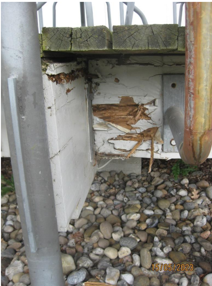
Udbredt råd i bærende limtræsdragere under terrasse
