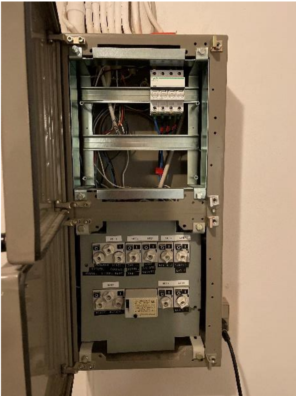
Tavle i depot ved omklædning 3 som mangler afdækning
