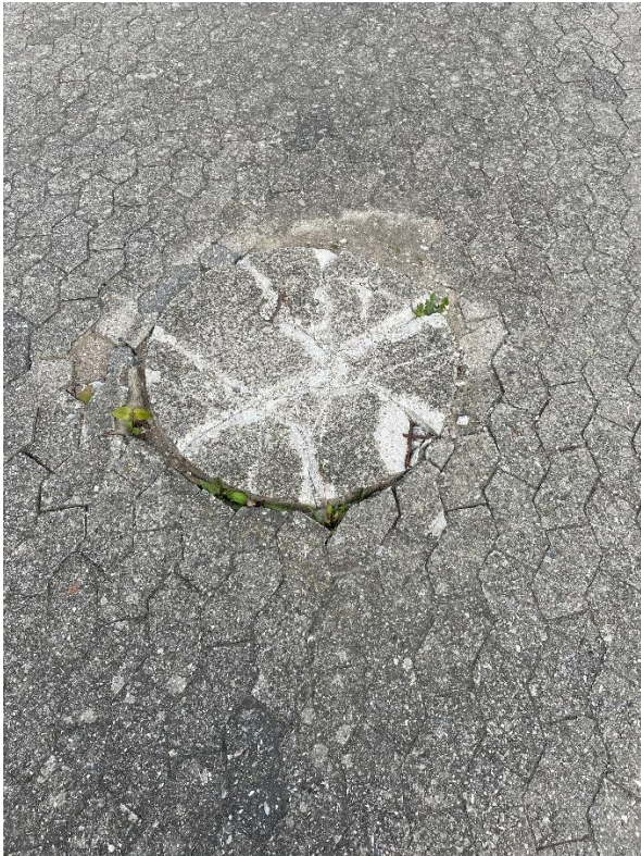
Betondæksler som bør skiftes til støbegods
