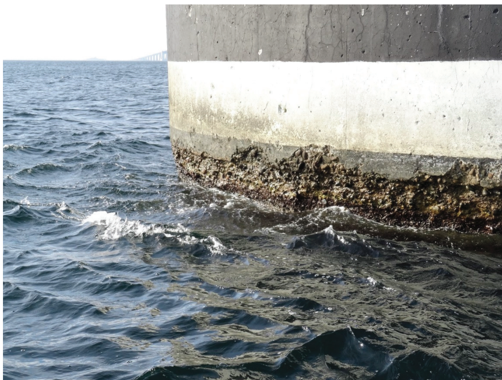
Foto 15: Eroderet beton omkring daglig vande på det nordlige molehoved.
