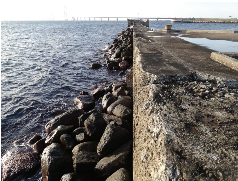
Foto 6: Manglende sten på ydersiden af den sydlige mole ved st. 360.
