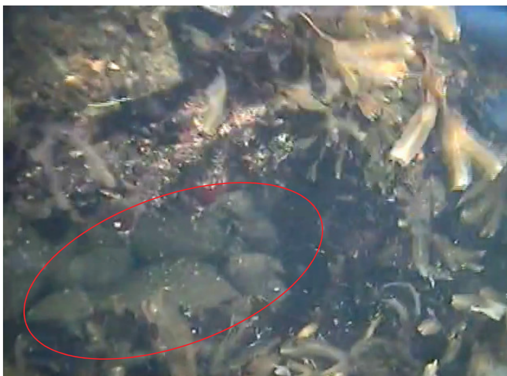
Foto 10: Lokal underminering af molens betonoverbygning, den underliggende stensætning er synlig.
