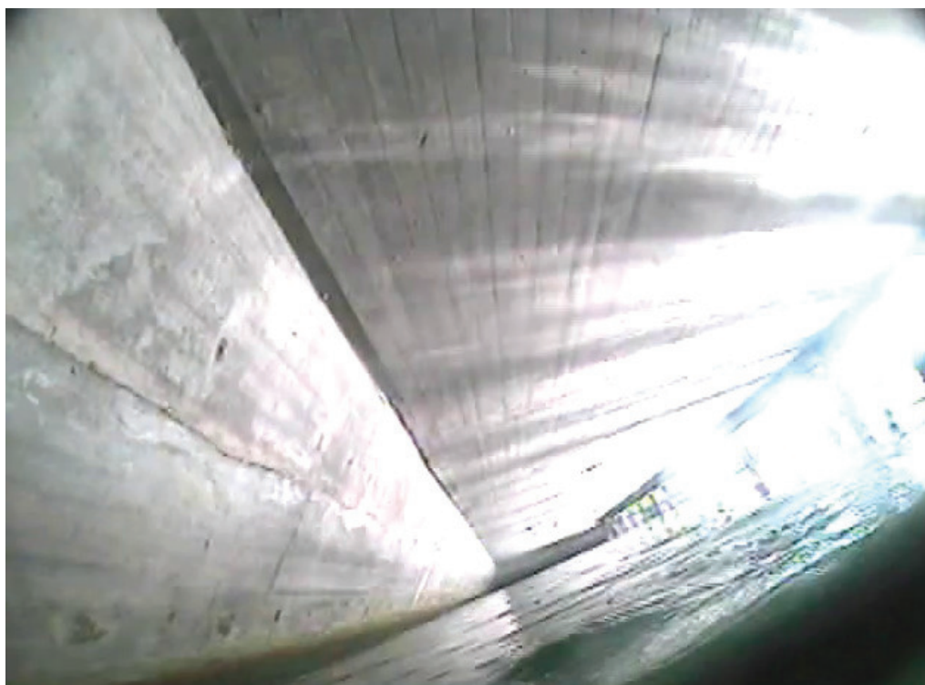
Foto 25: Sund beton på undersiden af Oliepieren.
