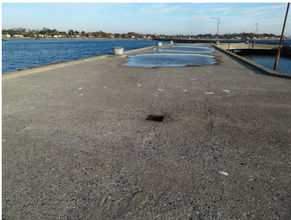
Foto 24: Korroderet afløbsrist og afvandingsproblemer på overfladen af Oliepieren.
