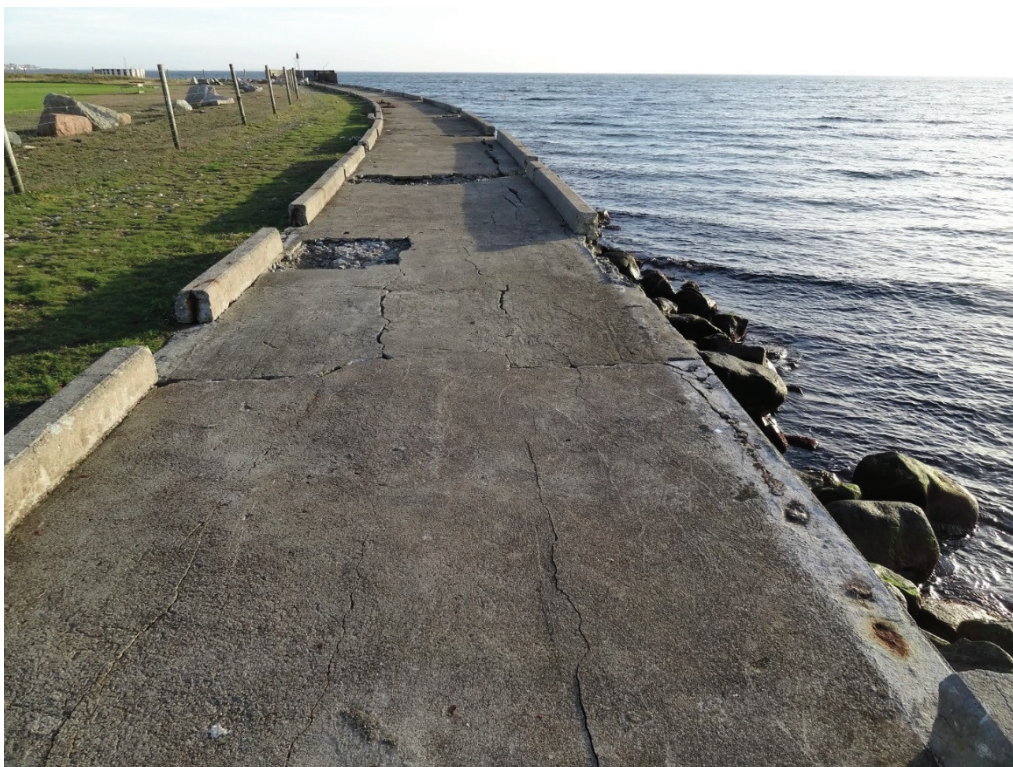
Foto 5: Revnet belægning og manglende hammer på den nordlige mole ved st. 200.
