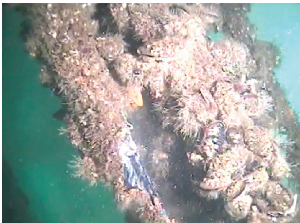
Foto 28: Anoder på stålpele med 0% tilbageværende anodemateriale.
