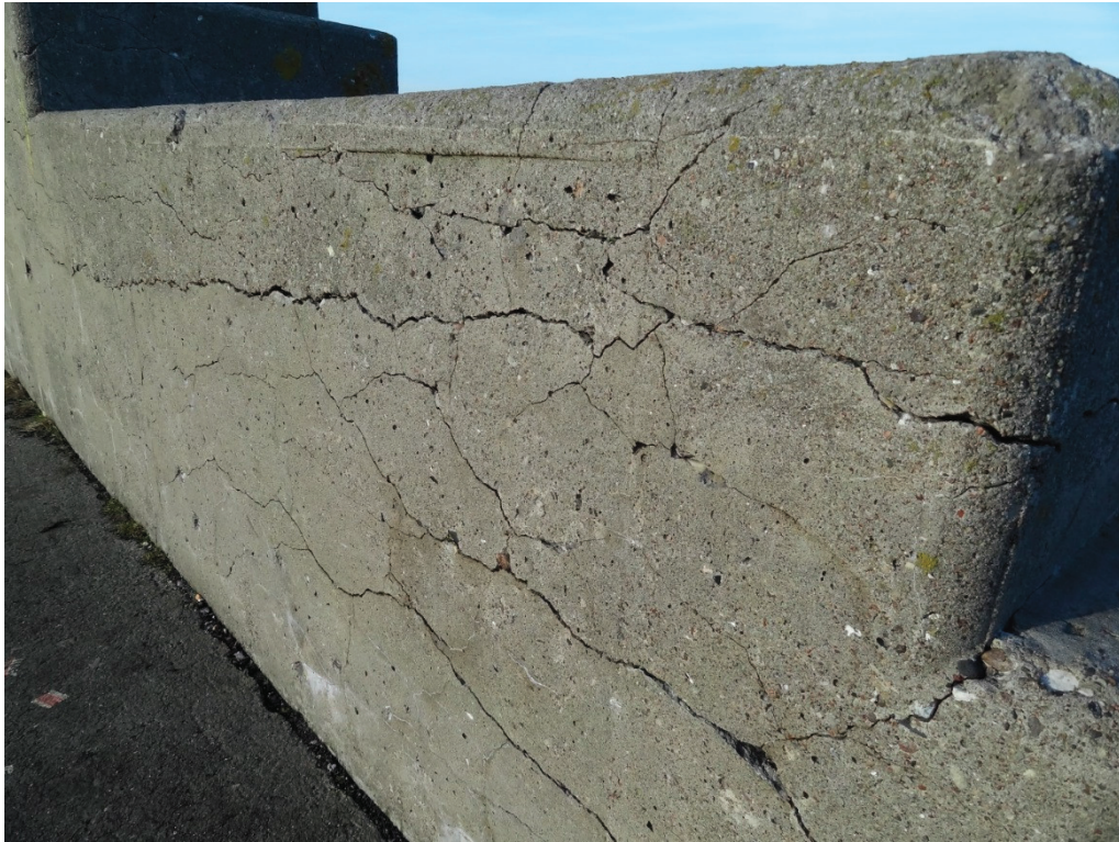
Foto 13: Revner i bølgeskærmen på det sydlige molehoved.
