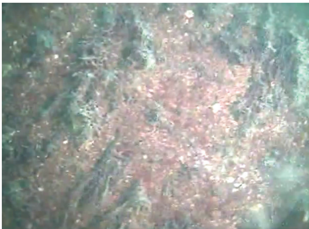
Foto 16: Sund beton under daglig vande på det sydlige molehoved.
