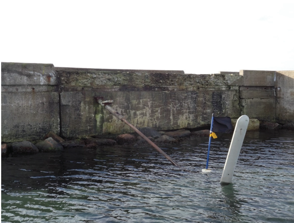
Foto 8: Beskadiget lygtepæl på den sydlige mole ved st. 300.
