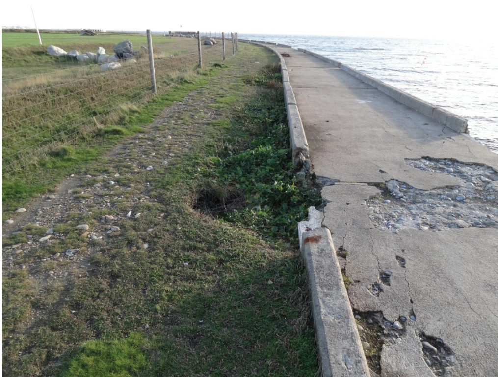
Foto 7: Sætninger i belægningen bag den nordlige mole ved st. 200.
