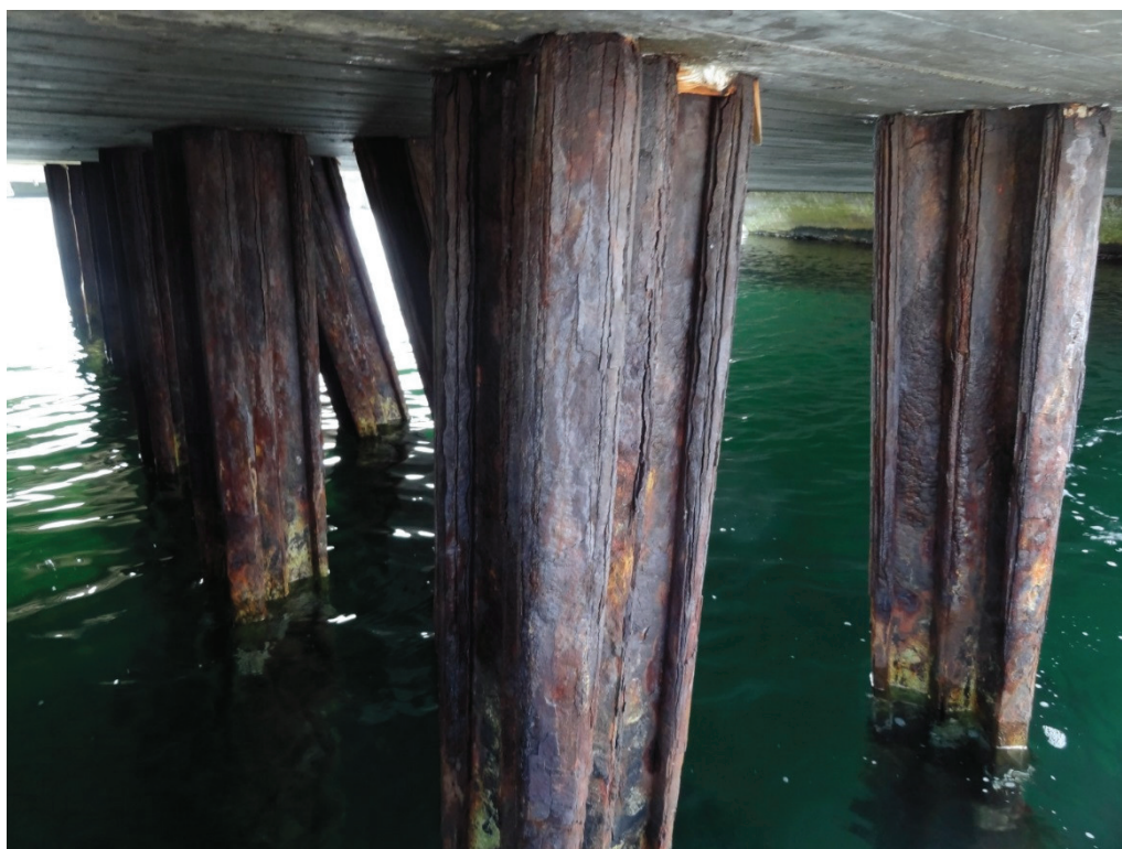
Foto 23: Korroderede stålpele over vand.
