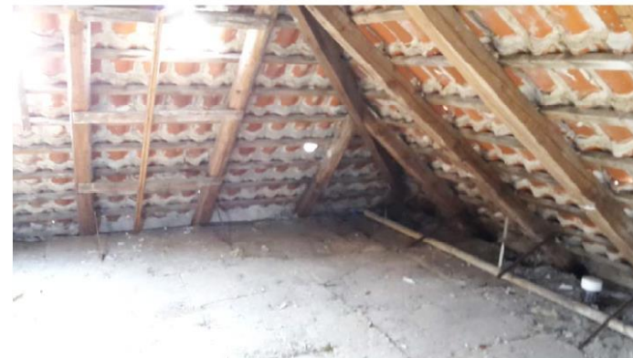
Foto 1: Understrygning i tagrum
