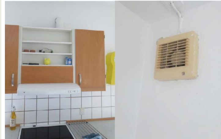
13: Emhætte med afkast via facade og udsugningsventilator i badeværelse
