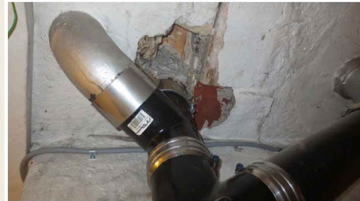
Foto 15: Oprindelige og nyere afløbsrør under kælderloft
