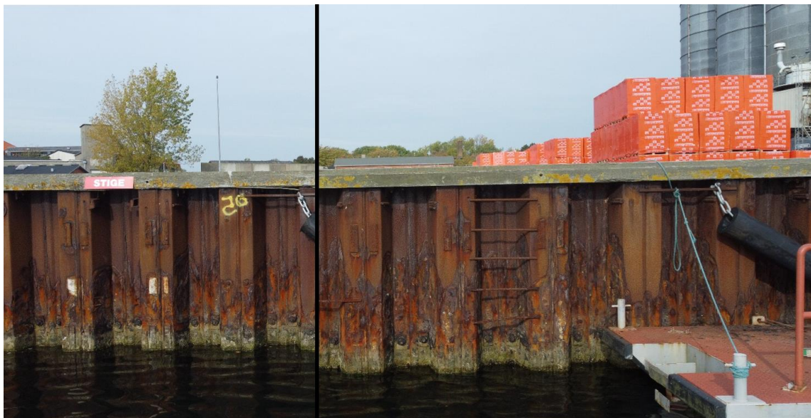
Figur 10: Manglende redningsstige tv. Mindre synlig redningsstige th.
