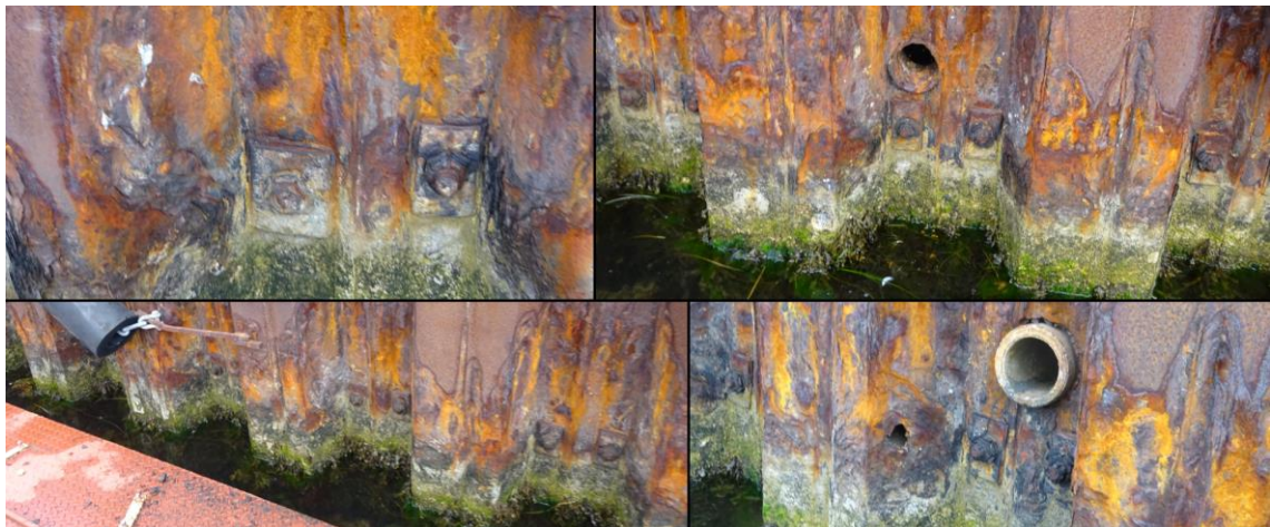
Figur 17: Kraftig korrosion af hovedbolte på udvendig side.
