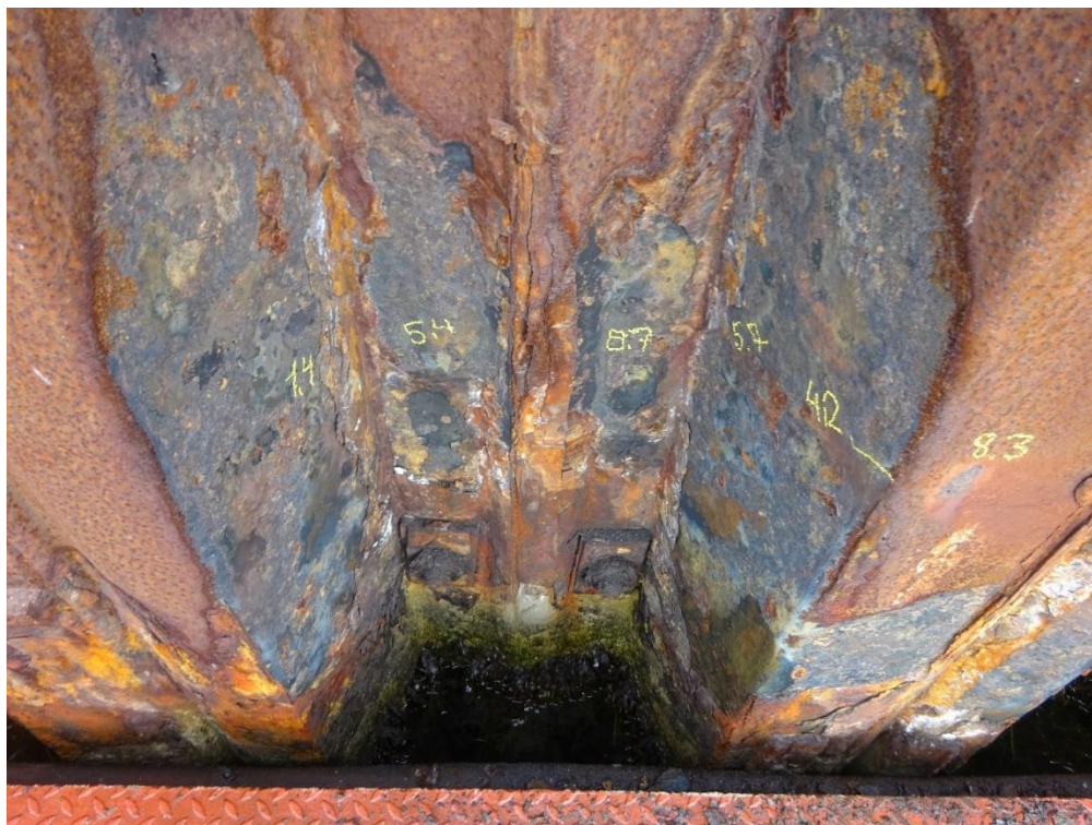
Figur 15: Kraftig korrosion af spunsprofil, viser tykkelsesmålingerne.
