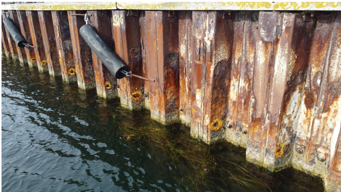
Figur 5 – Mønster af markerede huller i spunsvæggens krop.
