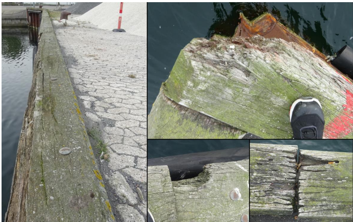
Figur 18: Hammer i dårlig stand. Generelt ikke i særlig god stand, men flere steder er den stadig intakt.
