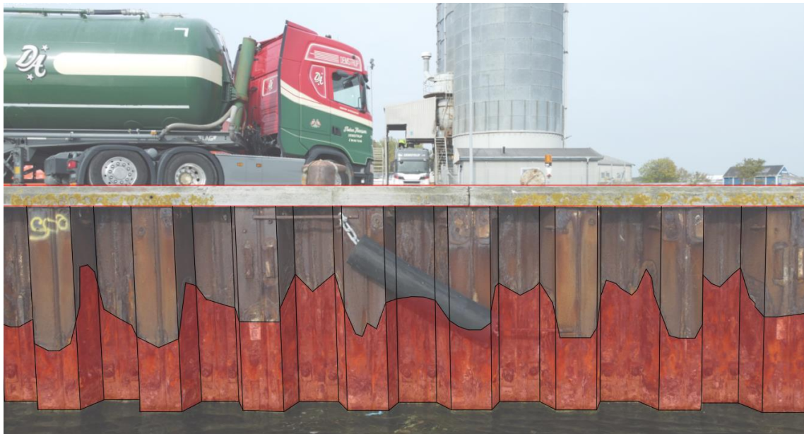
Figur 4 – Mønster af korrosion, omkring station 200.
