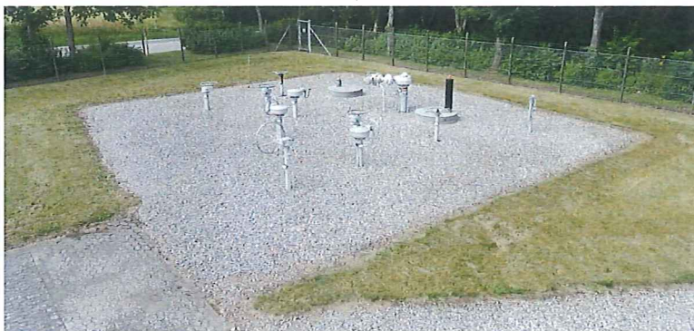
Eksempel på linjeventilstation
