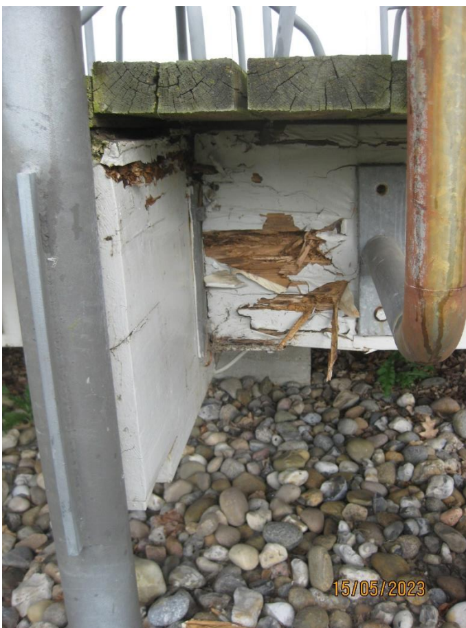
Udbredt råd i bærende limtræsdragere under terrasse
