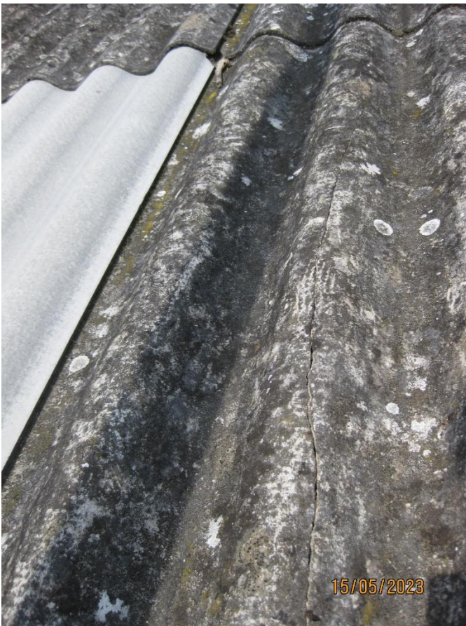
Revnet bølgeeternittag på varmecentralen.
