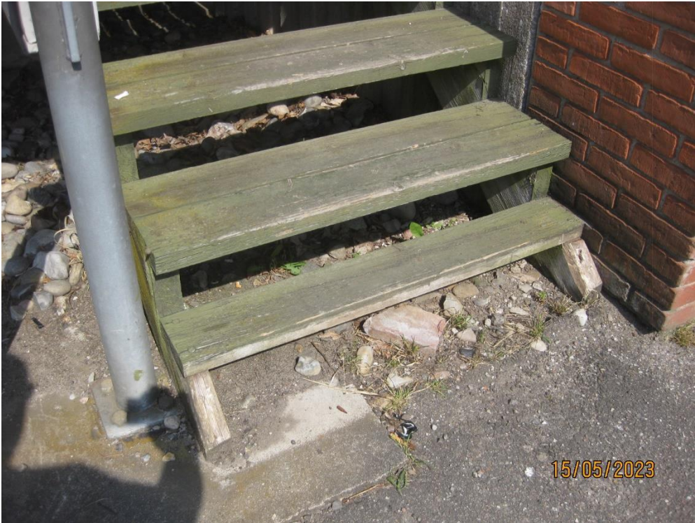
Nederste trin på terrassetrappe er defekt/mangler delvist
