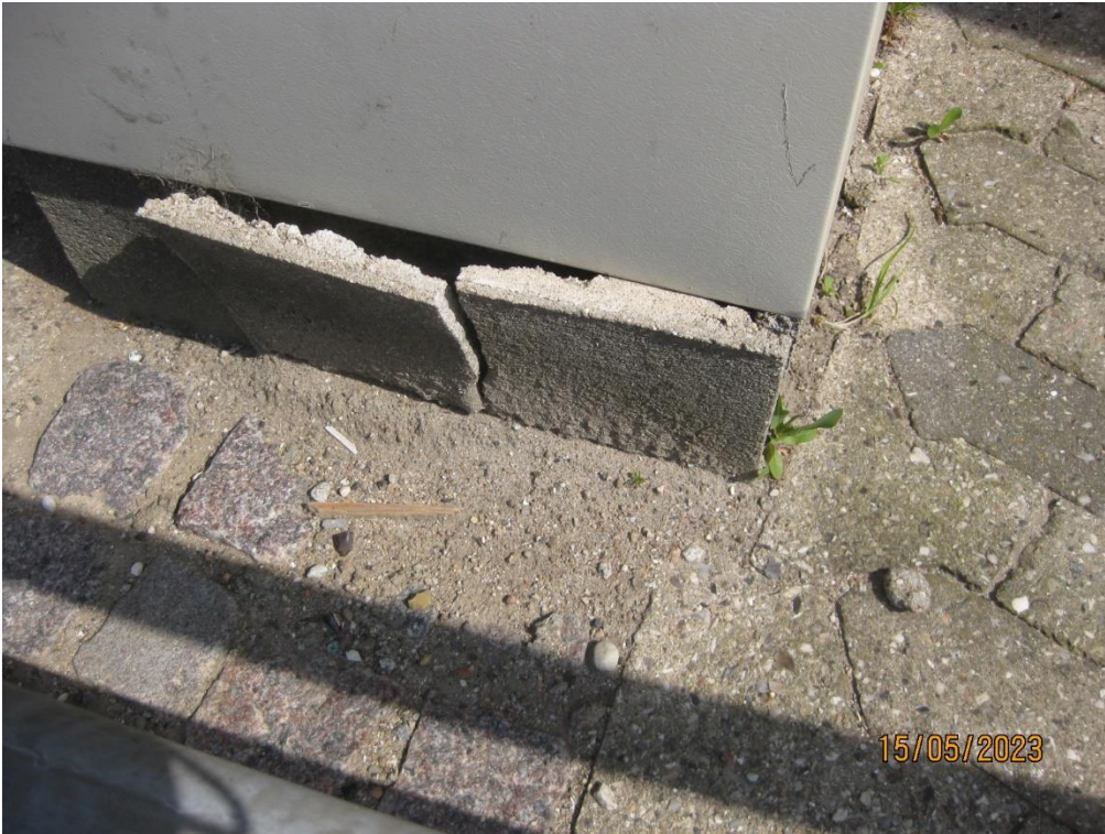
Afslag af sokkelpuds på søjler
