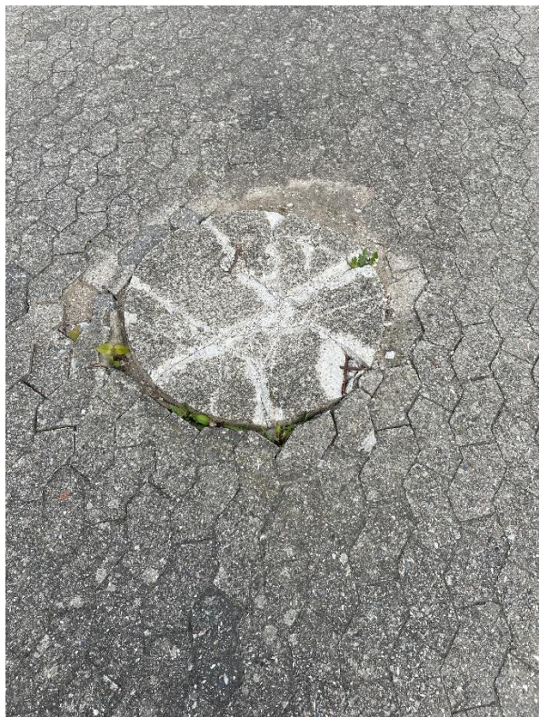
Betondæksler som bør skiftes til støbegods
