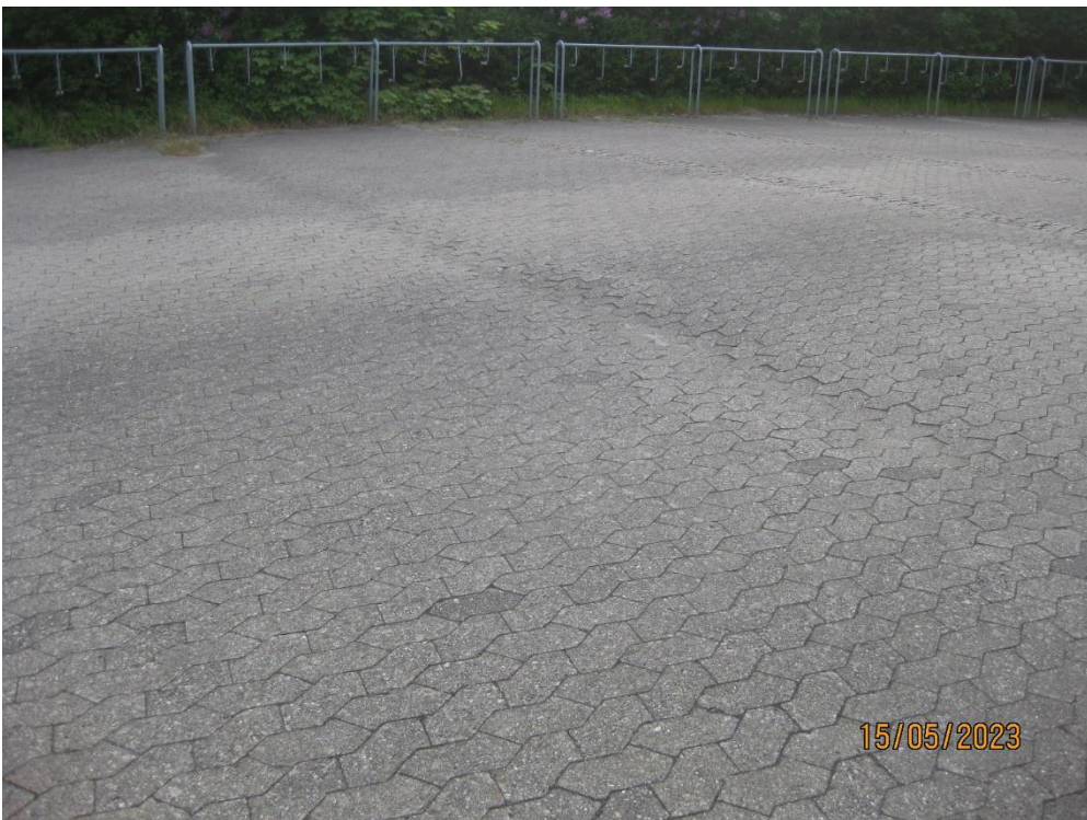
Lunke i belægning ved hovedindgang
